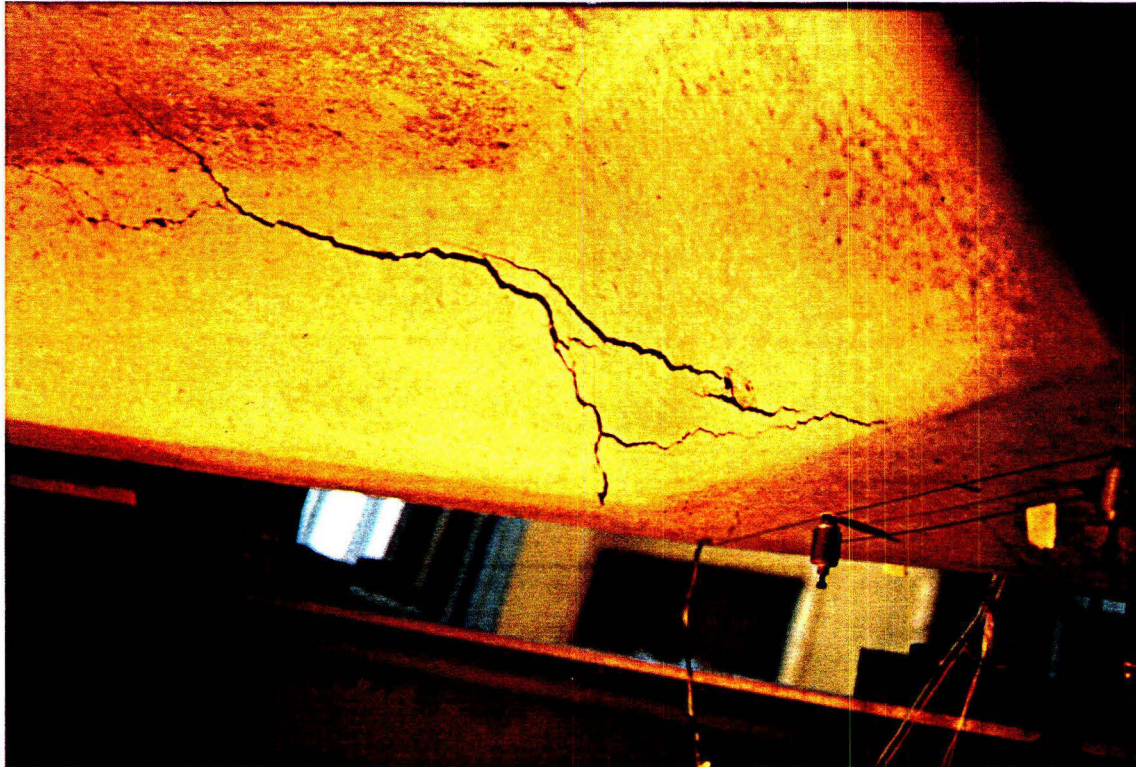
foto 14: proef 3, scheurpatroon rechter hoek, onderzijde
