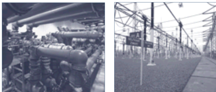
Verdeelstations in het elektriciteitsnet
