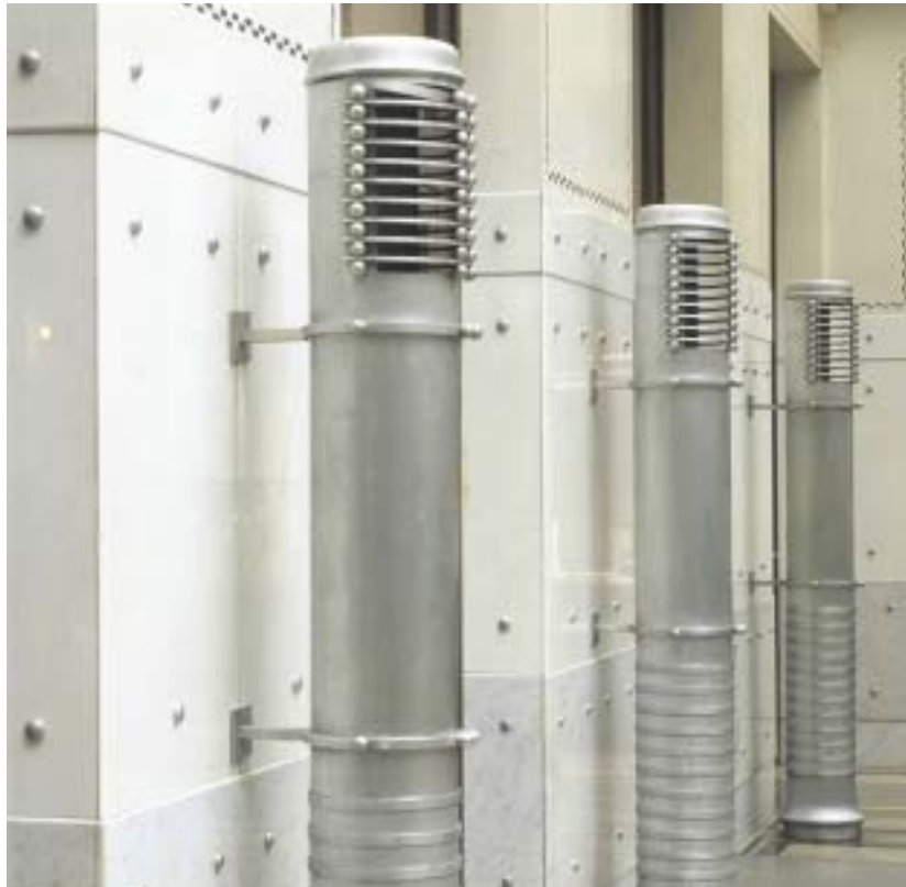
Figuur 45. De toegepaste aluminium luchtbehandelingsinstallatie.
