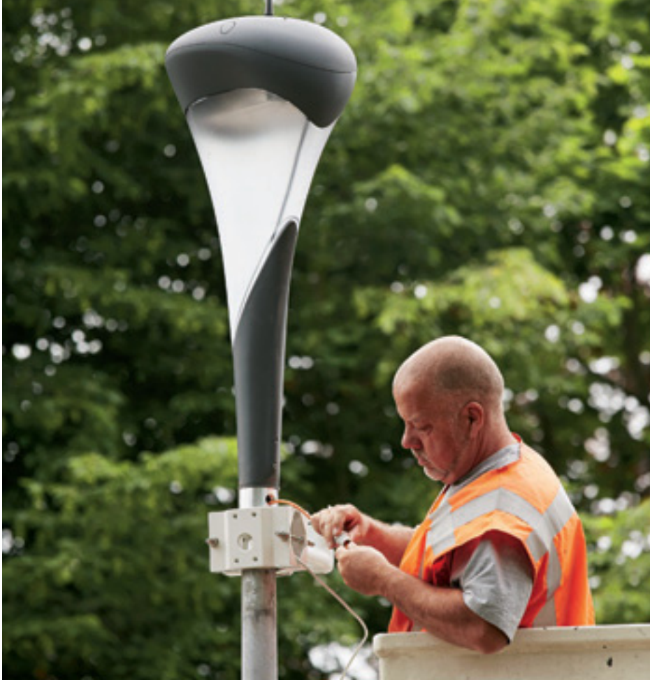
Installatie van een sensorbox op een lantaarnpaal die onderdeel is van de testcase in Eindhoven
