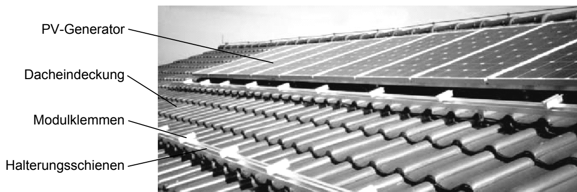
Bild 20 : Aufdachmontierter PV-Generator auf einem Schrägdach
