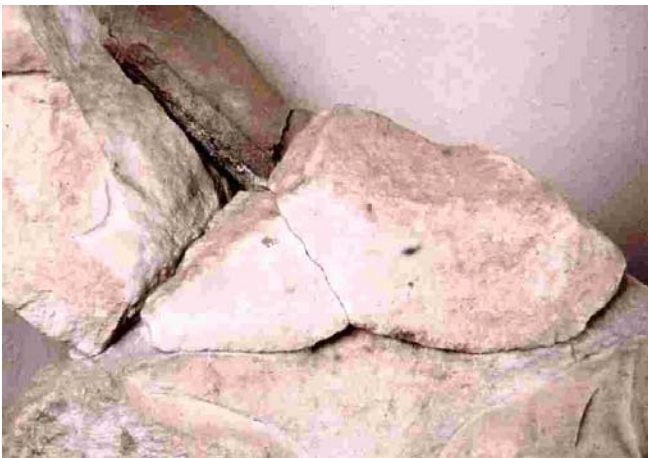
Abbildung 18: Sprengwirkung von verrostenden Eisendübeln am Telephosfries
