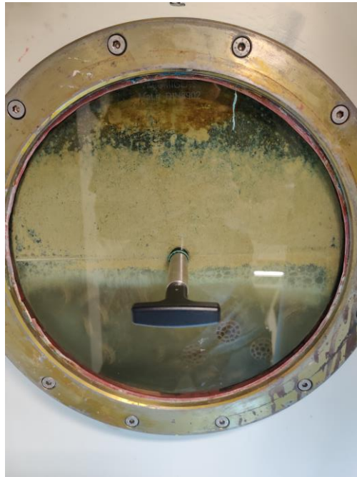
Figura 19. Bacterias dentro del tanque biorreactor
