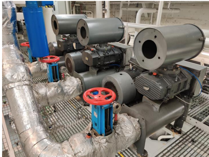
Figura 18. Sopladores de aire
