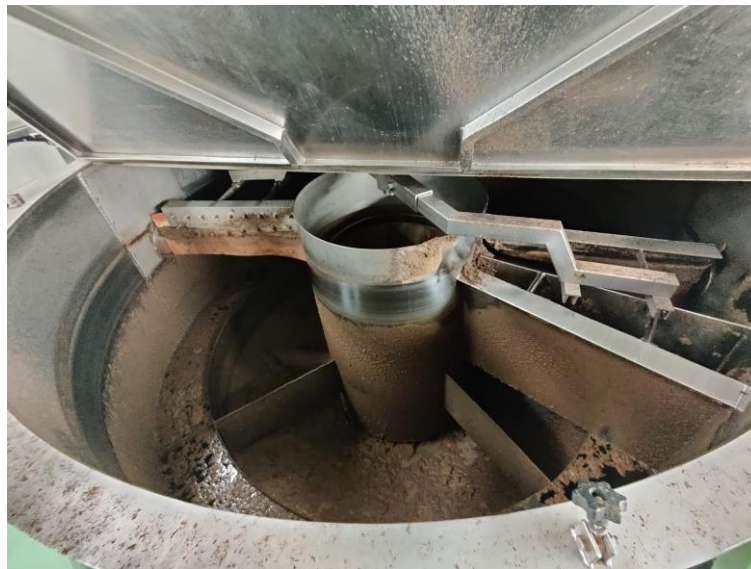
Figura 24. Detalle del Flotation Module durante su vaciado para limpiar
