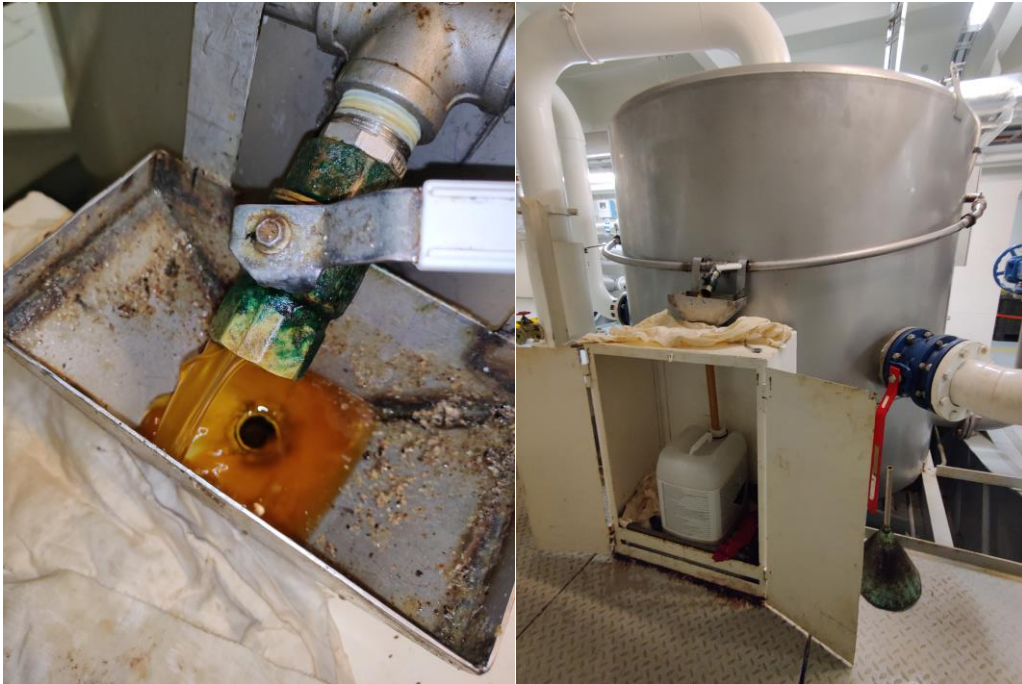
Figura 11. Drenaje manual de la grasa en una garrafa
