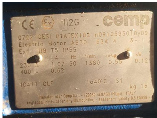
Imagen 19. Característica de motor eléctrico imagen 16.
