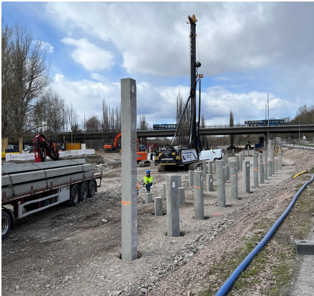
Figur 6. Pålning med cementpelare i porösa lerjordar ger direkt förbättrad hållfasthet och den slutliga hållfastheten är lättare att förutspå. I bakgrunden en pålkran med hög svart mast. Helsingfors, 4.5.2022.
