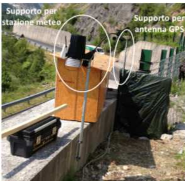
Figura 8.47 Dettaglio dei supporti per la stazione meteo e l'antenna GPS.
