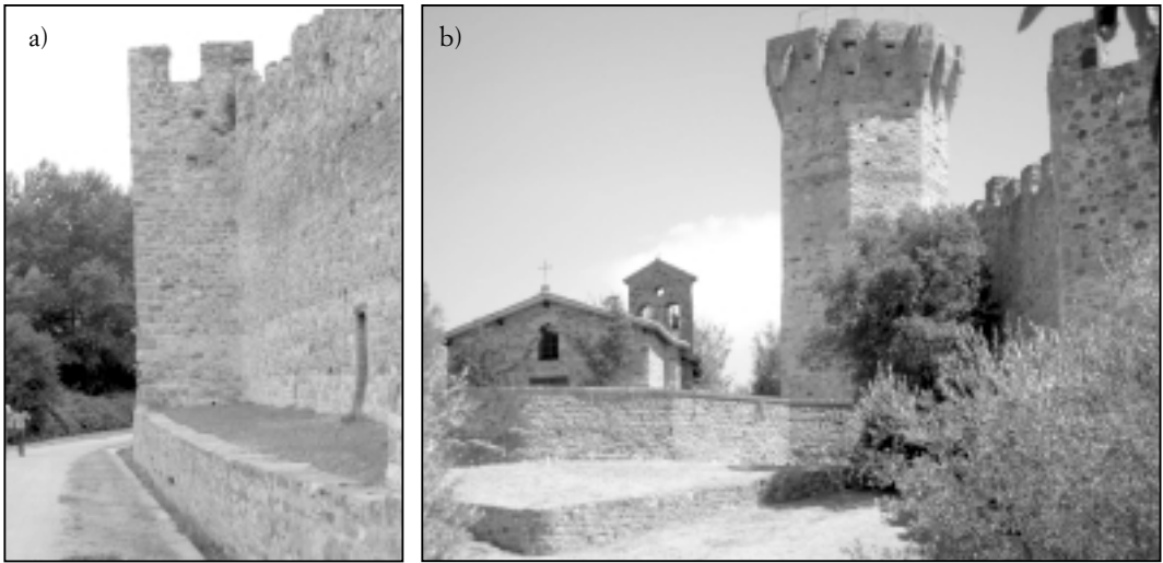
FIGURA 8 – a) La strada del percorso costeggia il Castello dell'Isola Polvese con torri e merli ben conservati. Le mura sono realizzate con blocchi di arenaria (Macigno; Jacobacci et alii, 1970) e calcarenite; b) La Chiesa di S. Giuliano presso la torre ottagonale del Castello (foto L. Gregori).
