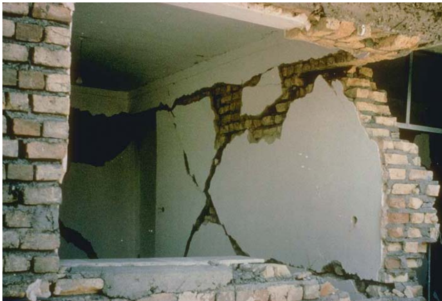
FIGURA 1: MURATURA DANNEGGIATA DAL SISMA
