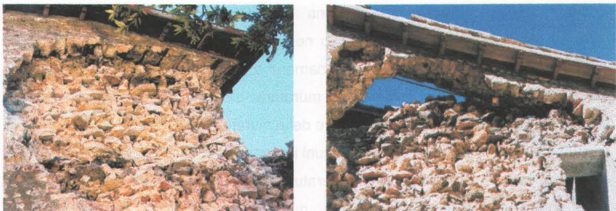
Fig. 7: Espulsioni dello strato esterno di murature a più paramenti accostati.
