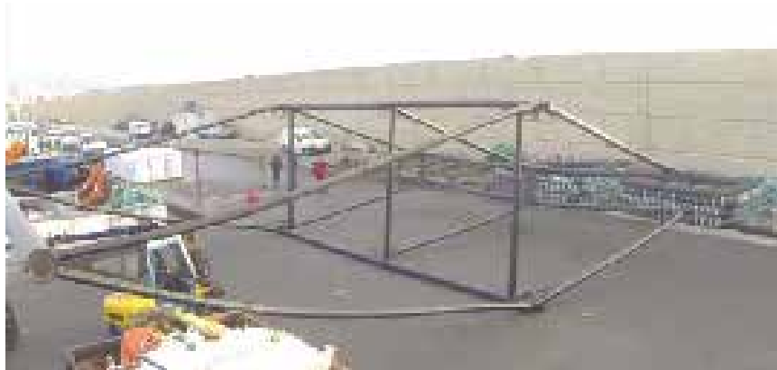
Figura 14. Imagen de la estructura en el muelle antes de proceder a su transporte a la granja.
