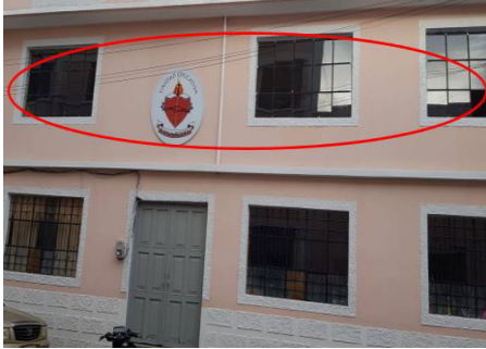
Figura 16. Identificación falla tipo parapeto que se puede caer
