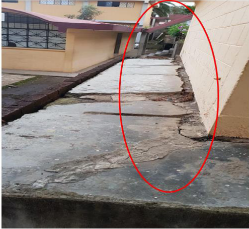
Figura 12. se puede observar una falla de tipo revestimiento e irregularidad en planta
