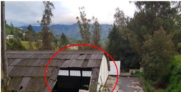
Figura 20. Se observa “una falla de tipo parapeto”.
