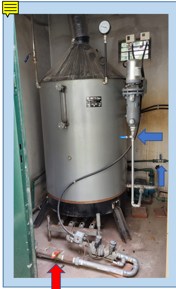
Figura 3: Caldera a vapor de 700 L.
