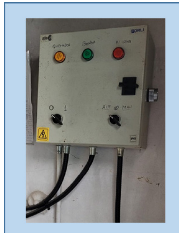
Figura 5: Tablero de encendido de caldera de planta piloto de Agroindustrias
