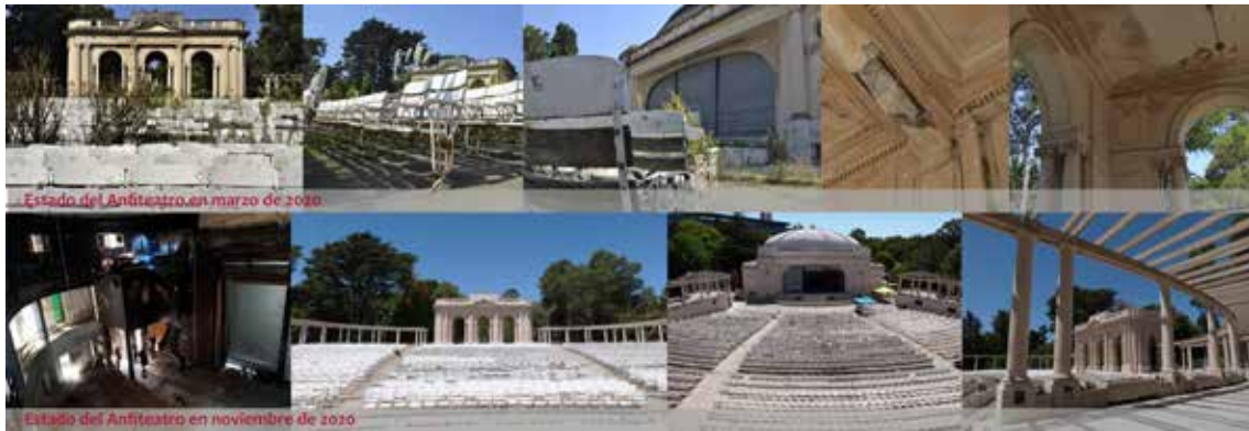
Fig. 12. Estado actual del Anfiteatro, su estado de riesgo. Fuente: Elaboración propia. Imágenes de marzo de 2020 de autoría propia. Imágenes de noviembre de 2020 grupo de Facebook “Intentar, Teatro del Bosque Patrimonio Platense”.
