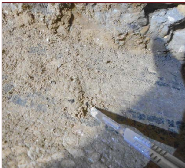
Fig. 29: Pesanti concrezioni calcaree presenti sulla superficie del pavimento musivo.
