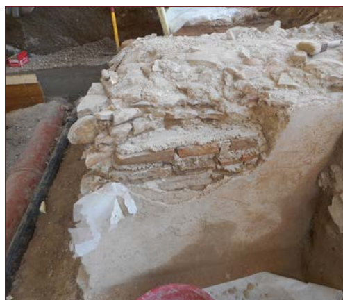
Fig. 67: Settore produttivo. Ripristino delle lacune murarie e messa in sicurezza dei rivestimenti parietali.
