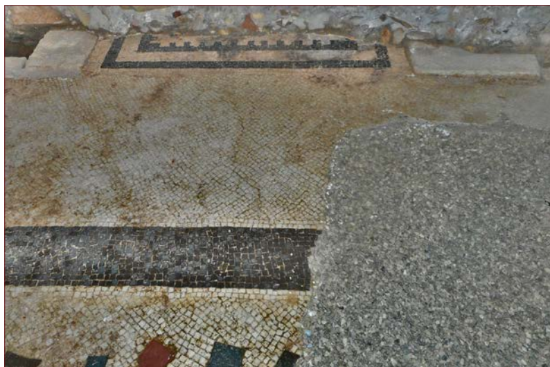
Fig. 23: Soglia mosaicata del passaggio fra il stanza (7) e il cubicolo (6) con decorazione a dentelli.
