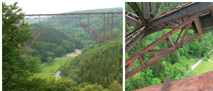
Abbildung 1.1: Korrosion an der Müngstener Eisenbahnbrücke in Solingen [5]
