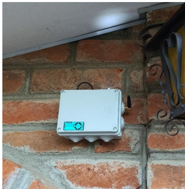
Ilustración 32. Medidor ubicado en Santa Ana.
