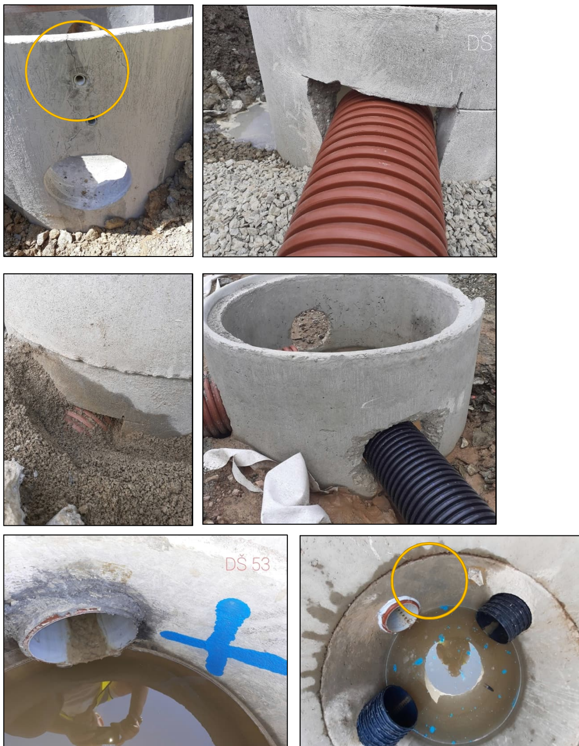
Obr. 33 a, b, c, d, e, f Vady na šachtových dnech (foto autorka DP)
