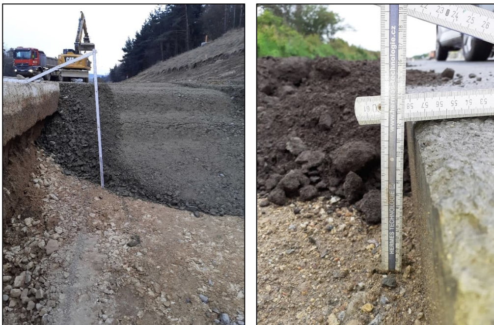
Obr. 20 a, b Kontrola tloušťky vrstvy (na obr. a je provádění vrstvy štěrkodrti – nasypáno najednou cca 65 cm – v rozporu dle ČSN, neboť hutnění má probíhat po vrstvách max. 30 cm, na obr. b je měření tloušťky asfaltového recyklátu – dle PD měla mít tloušťku 15 cm, zde bude cca 10 cm) (foto autorka DP)
