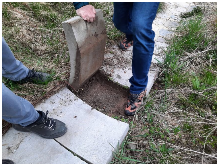
Obr. 22 Nesprávně podbetonované příkopové tvárnice, jsou uvolněné (foto autorka DP)
