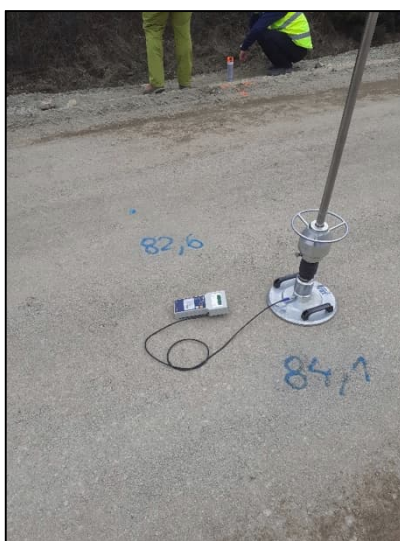
Obr. 19 Kontrola provádění zkoušek (pozn. opakovaná opravná zkouška lehkou dynamickou deskou na za studena recyklované vrstvě, TDS vyznačil místa a výsledky předchozích nevyhovujících zkoušek) (foto autorka DP)
