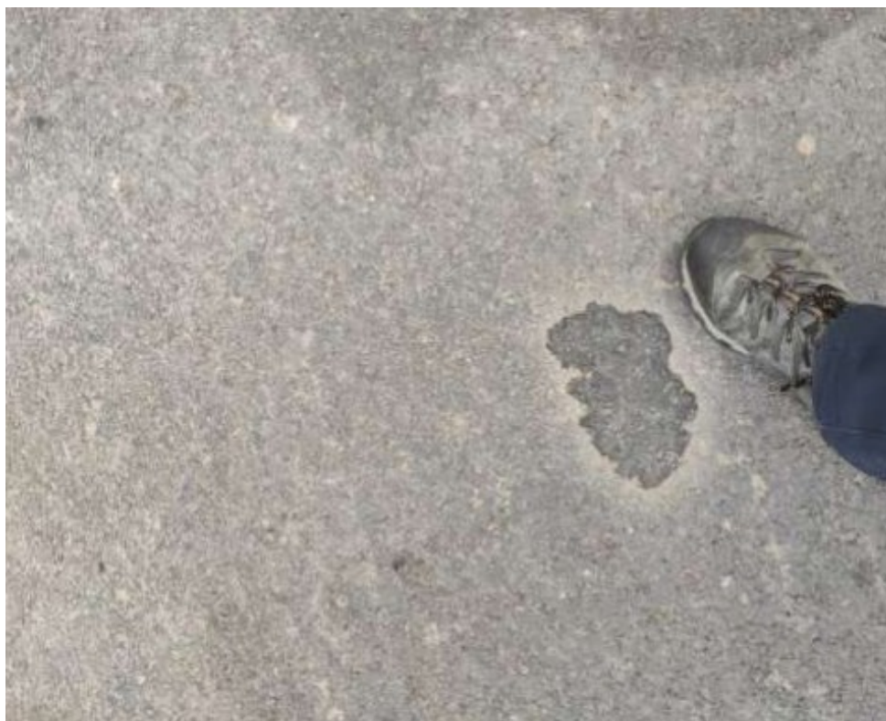
Obrázek 28- porucha 22, místní hrbol na úseku C
