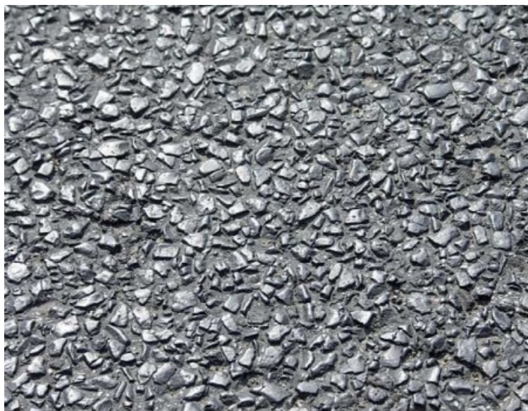
Obrázek 13- ztráta mikrotextury asfaltové vozovky [21]
