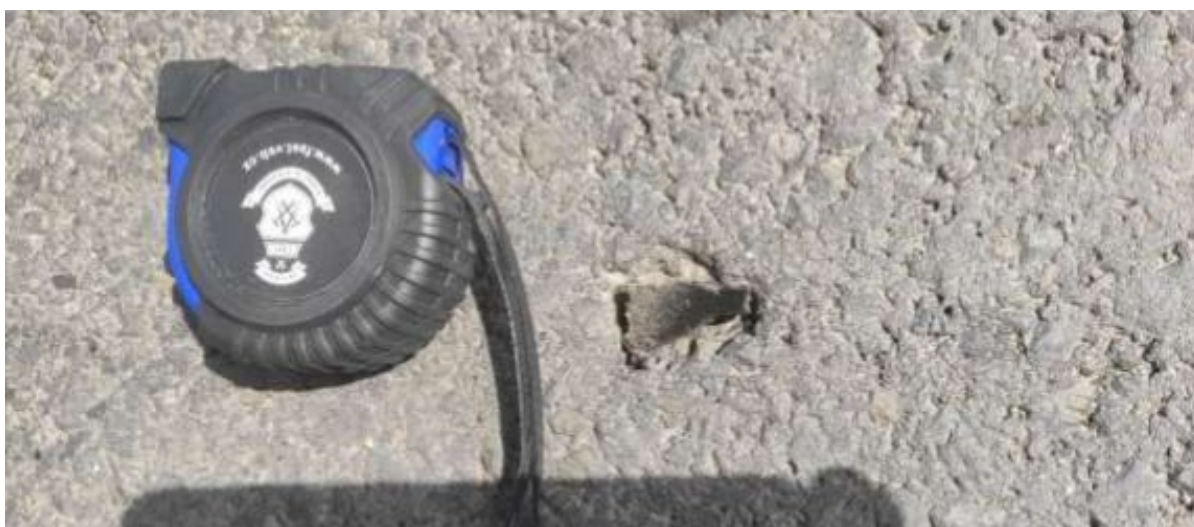
Obrázek 25- porucha 03, kaverna na úseku B
