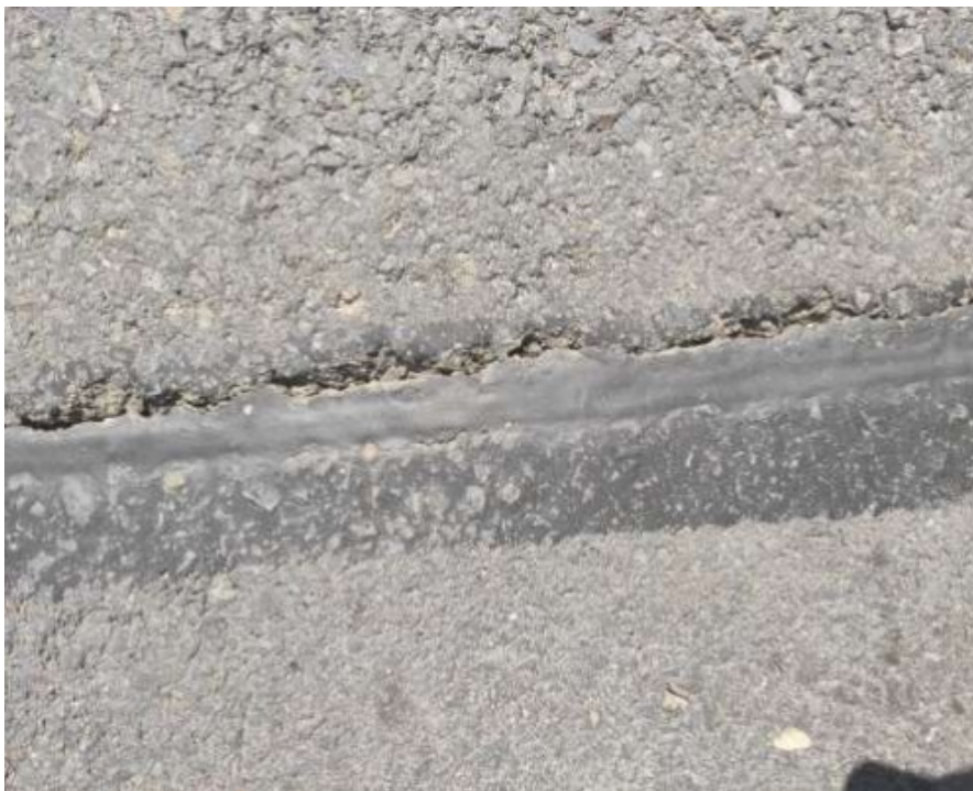
Obrázek 23 - porucha 12 úzká příčná trhлина v pracovní spáře na úseku A
