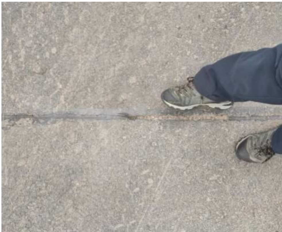
Obrázek 26- úzká příčná trhlina v pracovní spáře úseku B
