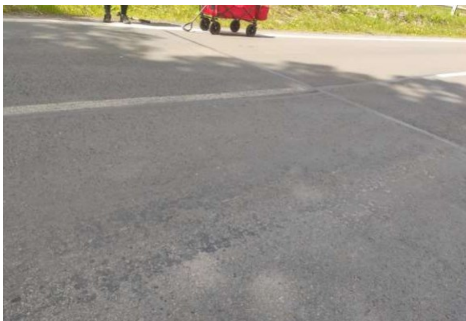
Obrázek 21- první porucha úseku A
