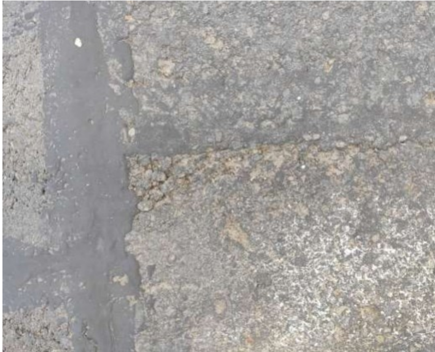
Obrázek 22- porucha 11, úzká podélná trhлина v pracovní spáře na úseku A
