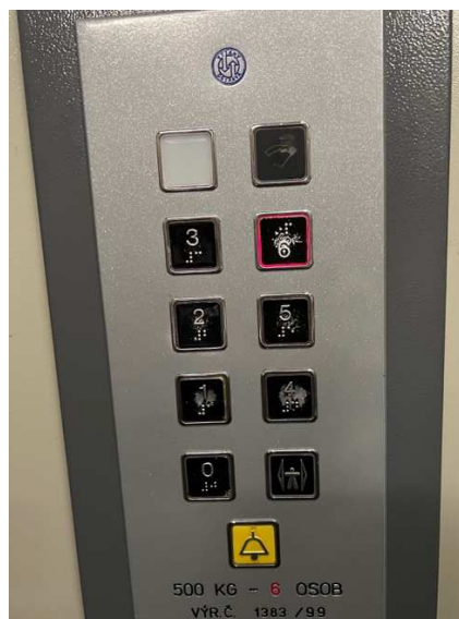
Obr. 18 Výtah. Ovládací prvek uvnitř kabiny
