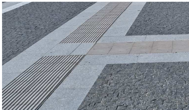
Obr. 2 „Umělá vodící linie a její křížení. Hmatové úpravy jsou tvořeny dlažebními deskami se speciální úpravou formou podélných drážek. Lemující rovinný pás šířky 250 mm je rovinný, bez výstupků, drážek a podobných tvarových úprav dle podmínek TN TZÚS 12.03.06“ [4].
