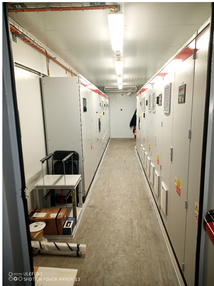
Obr. 7: Pohled do elektro kontejnerové rozvodny pro projekt AC-4057
