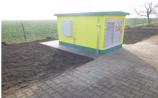
Obr. 11 Kiosková trafostanice DOFA3.2 C
