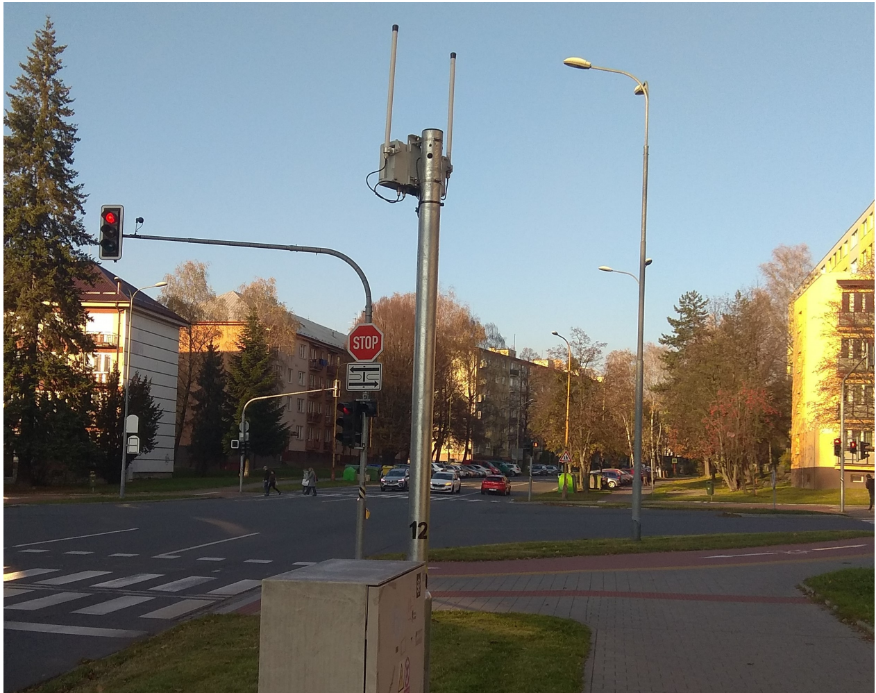
Obrázek 2.3: Jednotka RSU u křižovatky silnic ve městě Havířov
