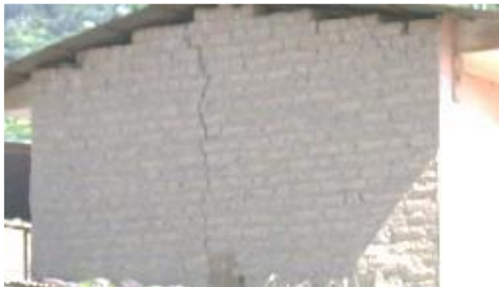
Figura 39 Falla por flexión que se propaga por el centro del muro
