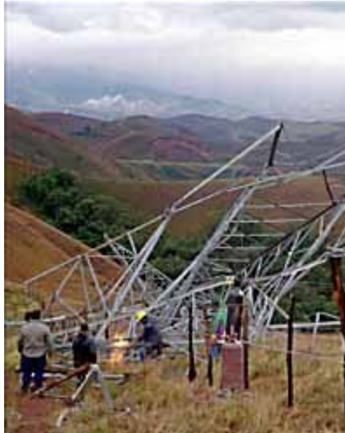
Figura 1.2 - Torre de transmissão destruída por vendaval em Cruzeiro-SP, em 2000. Fonte: (RIBEIRO, 2000)
