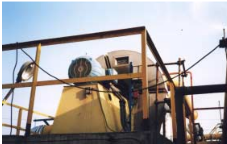
Figura 2. Foto do ventilador centrífugo
