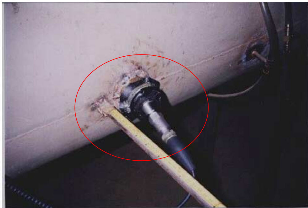
Figura 5.19 – Diafragma instalado na tubulação.
