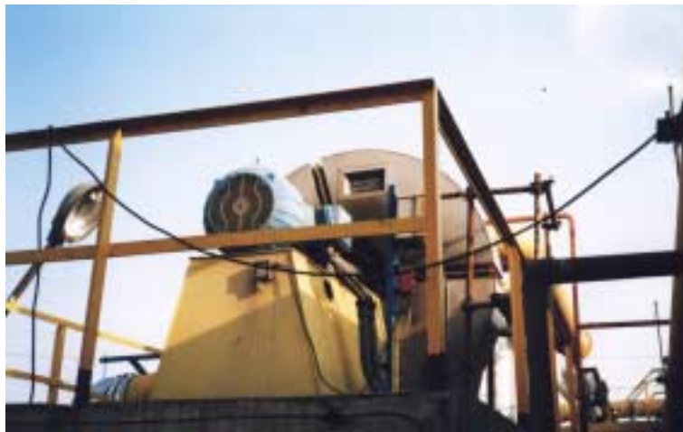
Figura 2.8 - Ventilador centrífugo – lado do acionamento
