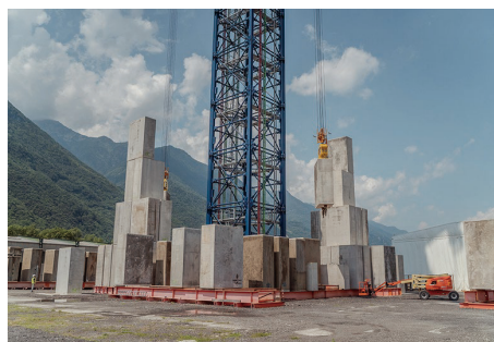
图 8 Energy Vault 公司复合砖储能塔
