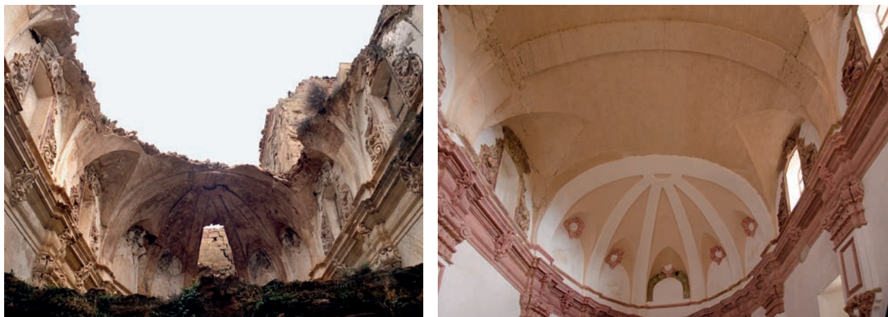
Fig. 4. Vista de las bóvedas de la nave y el presbiterio antes y después de la restauración. (Fotos: Asociación de Amigos del Castillo de Montearagón)
