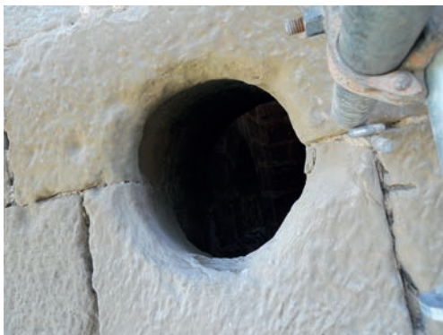
Fig. 27. Detalle de uno de los óculos del torreón, de 33 centímetros de diámetro, cuyo contorno aparece rematado en bisel.
