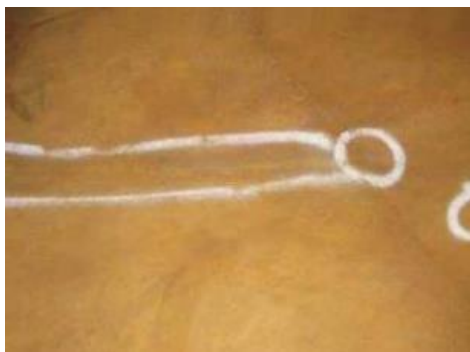
Рисунок 5 - Дефекты сварных соединений и вблизи угорного шва
