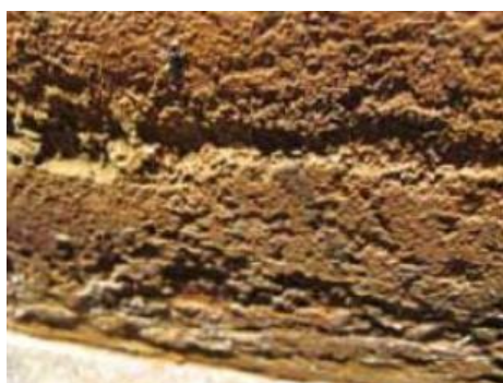
Рисунок 4 – Коррозионные дефекты, вызванные воздействием подтоварной воды
