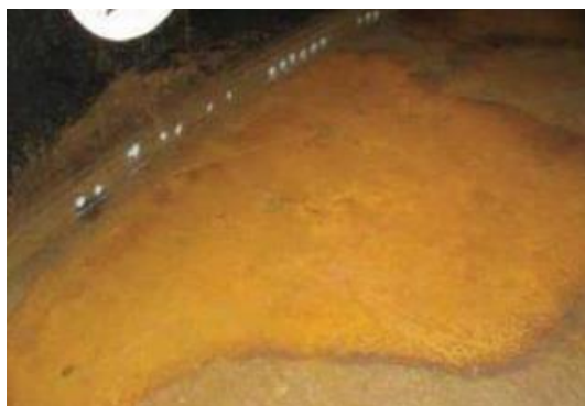
Рисунок 6 - Дефекты сварных соединений и вблизи угорного шва
