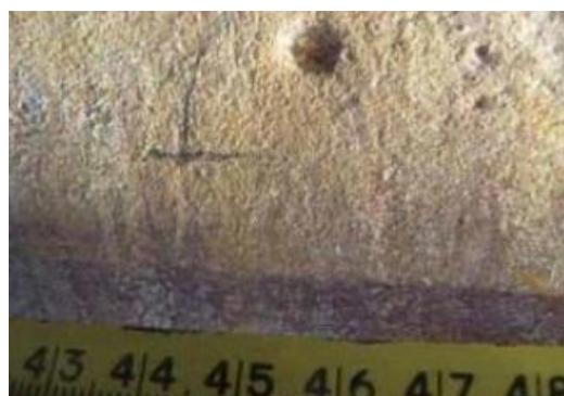
Рисунок 3 – Питтинговые дефекты днища резервуара
