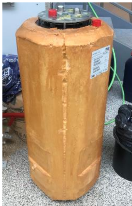
Figura 4.2 Deposito Lapesa RD 50-1.
