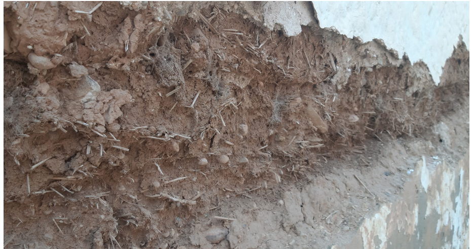
Fig. 35: fachada de adobe mal conservada, Belchite.
