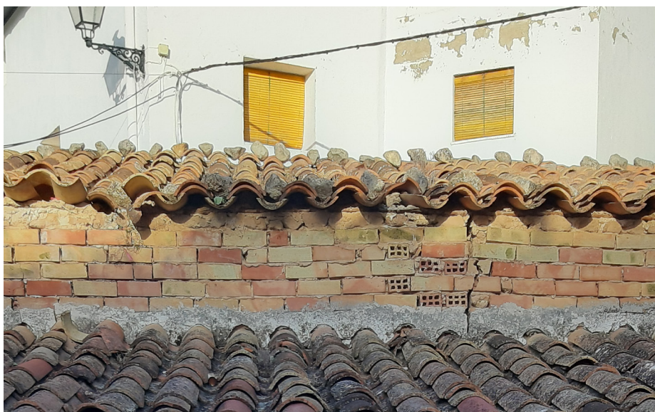
Fig. 45: ladrillos estropeados a causa de la humedad, Moneva.
