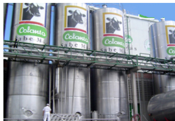
Tanques de almacenamiento de leche. Fuente: COLANTA
