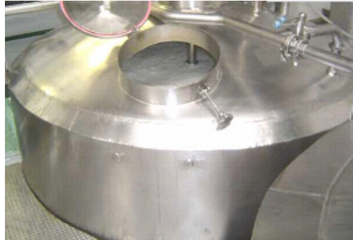
Tanque de Maduración. Fuente: COLANTA
