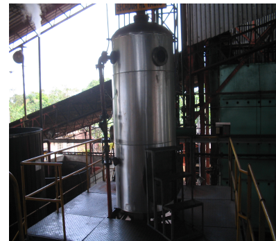
Foto 27. Clarificador Planta extractora
