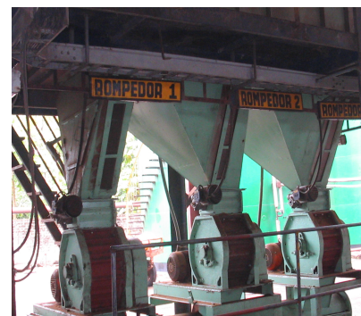
Foto 28. Palmistería Planta extractora
