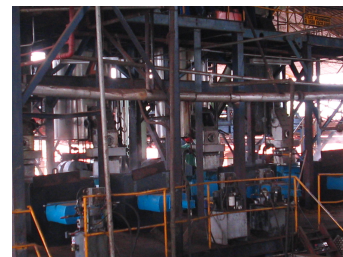
Foto 24. Prensado Planta extractora
