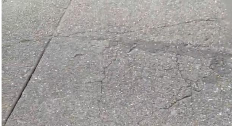
Grieta en bloque en pavimento rígido
