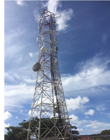
FIGUUR 1: Mast op St Eustatius
