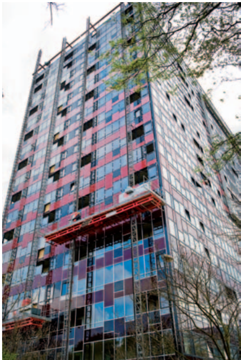
Om een flat uit de jaren '70 wordt van een glazen gevel gezet om én energie te besparen én het gebouw een eigentijdse uitstraling te geven.
