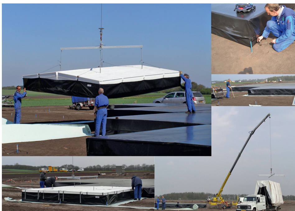
Fig. 5 Hier zien we de plaatsing van High Band Antennes op de LOFAR stations. Elke HBA is een tegel van 5 bij 5 meter met daarin 16 ontvangstelementen.
