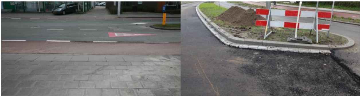
Figuur 3 en 4: Langsnaden tussen verschillende kleuren asfalt met de eerste schade daaraan (links). In de rechter figuur is duidelijk ontmenging te zien bij de aanleg van een doorsteek.
