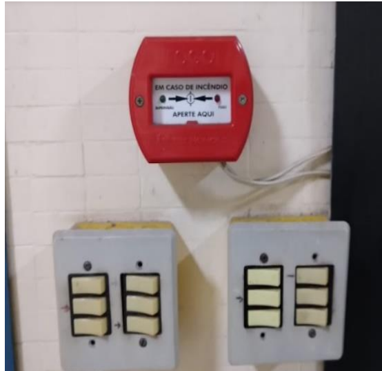
Figura 7. Botoeira de alarme existente (Autores, 2022).
