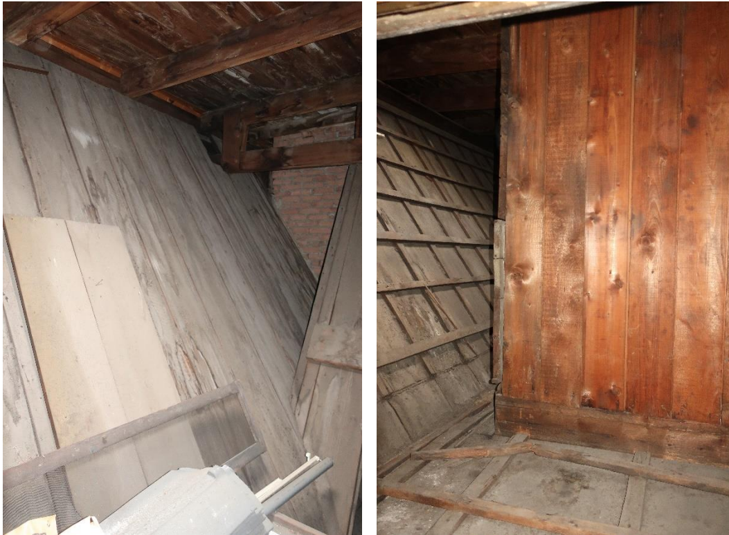
Nieuwezijds Voorburgwal 282, latere afdekking van de afzonderlijke dwarskappen ten behoeve van een zinken roevendak; ruimte tussen de middelste en voorste kap (rechts) met omtimmering van de lichtkoker voor de trap (foto's Jos Smit/ Monumenten en Archeologie).
