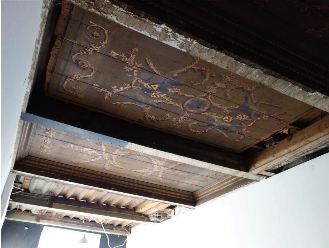
Singel 284, overzicht van de balklaag op de bel-etage (foto David Derksen/ Monumenten en Archeologie).
