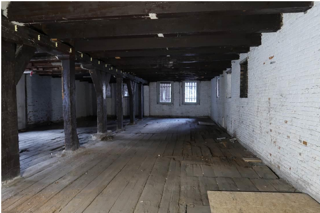
Brouwersgracht 167, eerste verdieping, balklaag met onderslagconstructie richting achterzijde (foto David Derksen/ Monumenten en Archeologie).
