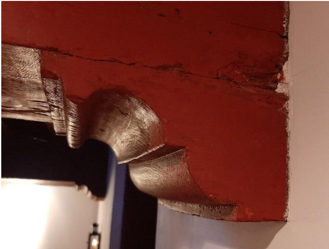
Console van de balklaag van de eerste verdieping in de rechter achtervleugel (foto auteur).
