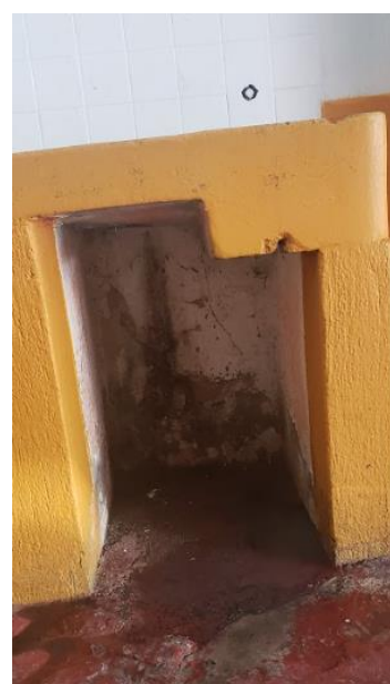
Figura 54.- Lavaderos sin instalaciones. Imagen propiedad del autor.
