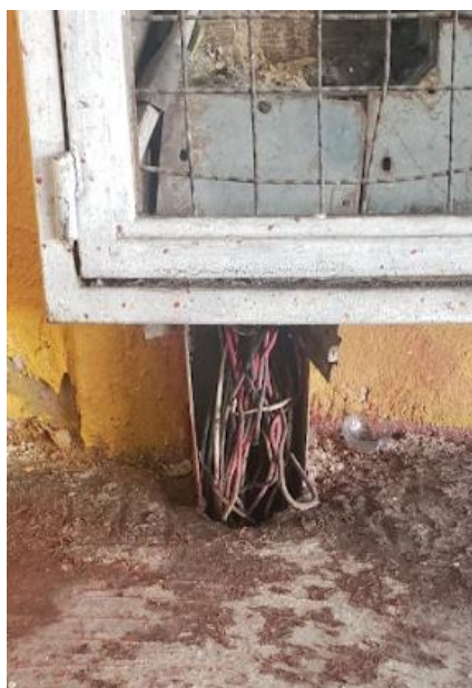
Figura 53.- Instalaciones eléctricas expuestas. Imagen propiedad del autor.
