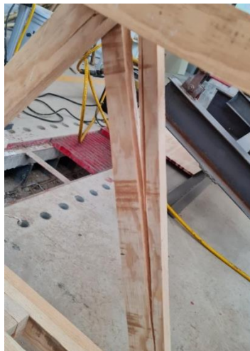
Figura 22. Falla en diagonal por cortante, rasgadas paralelas a fibras. Imagen propiedad del autor.
