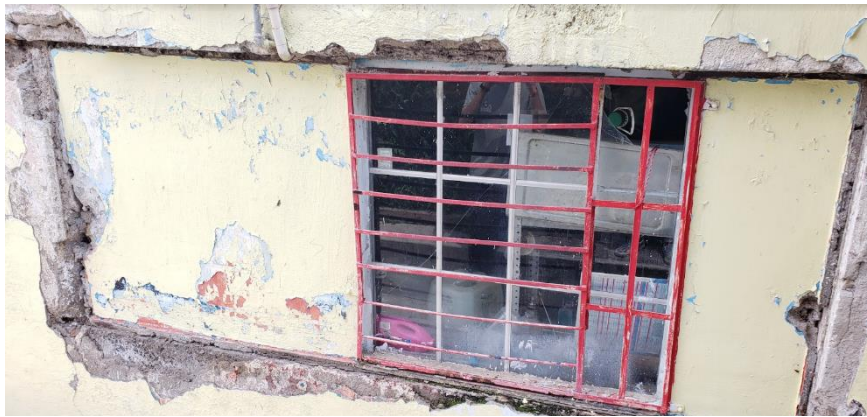
Figura 44.- Pérdida de sección del muro por el vano de la ventana. Imagen propiedad del autor.
