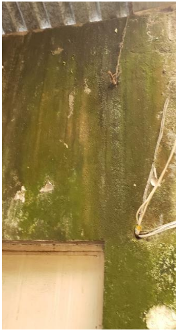
Figura 47.- Muros con presencia de lama debido a humedades Imagen propiedad del autor.
