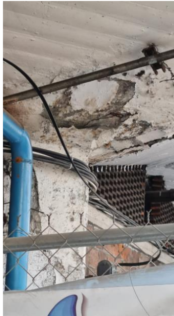
Figura 31.- Presencia de humedades en la losa. Imagen propiedad del autor.
