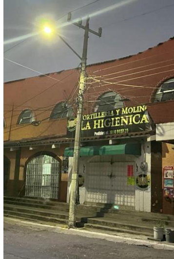
Figura 56.- Poste con cableado peligroso. Imagen propiedad del autor.
