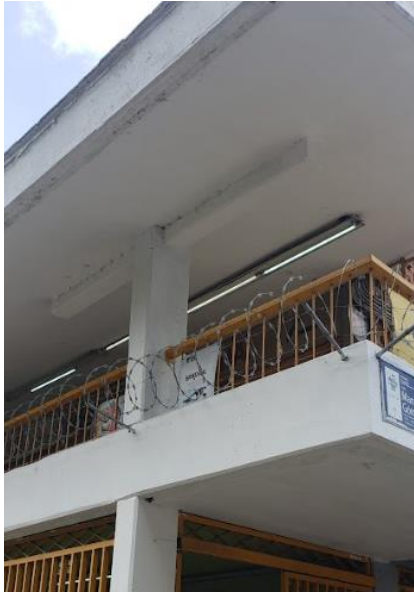
Figura 34.- Travesaños sin continuidad. Imagen propiedad del autor.
