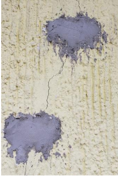
Figura 42.- Testigos activos por asentamiento diferencial. Imagen propiedad del autor.
