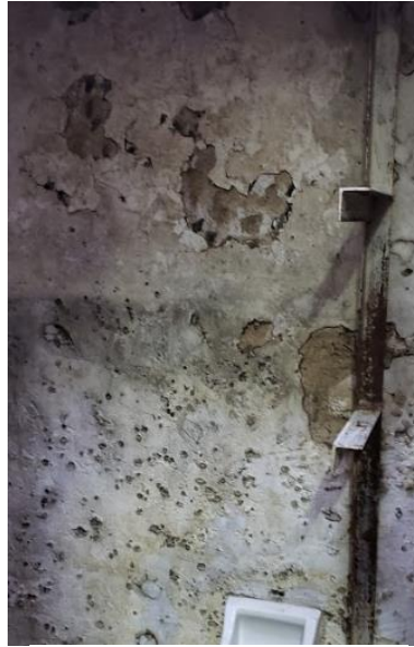
Figura 35.- Humedades serias en paredes de los baños de los locatarios. Imagen propiedad del autor.
