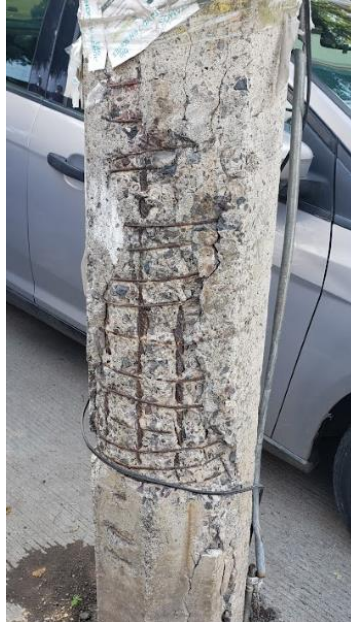
Figura 39.- Acero de refuerzo expuesto en poste de luz. Imagen propiedad del autor.
