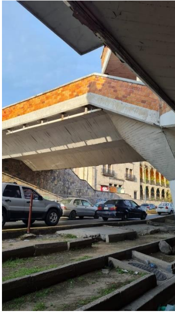
Figura 30.- Sistema prohibido en el reglamento de GDL. Imagen propiedad del autor.
