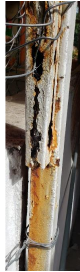
Figura 50.- Herrería con corrosión. Imagen propiedad del autor.
