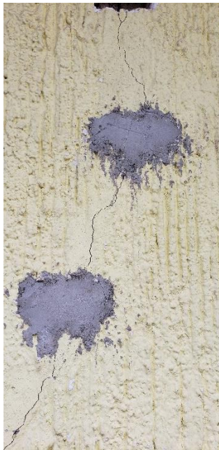
Figura 10. Grieta estructural en muro en mercado 1ro de Mayo. Imagen propiedad del autor.
