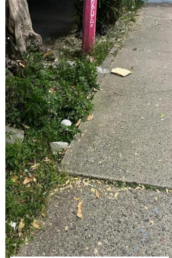
Figura 57.- Banquetas en mal estado. Imagen propiedad del autor.
