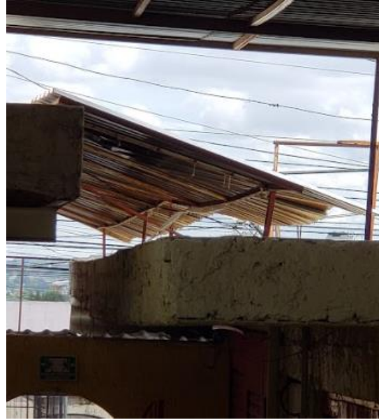
Figura 43.- Pandeos en cubiertas. Imagen propiedad del autor.
