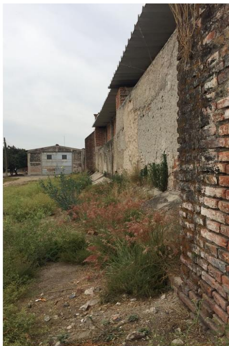
Muro fachada lateral Hda. Foto por: Manuel Lara (2018)
