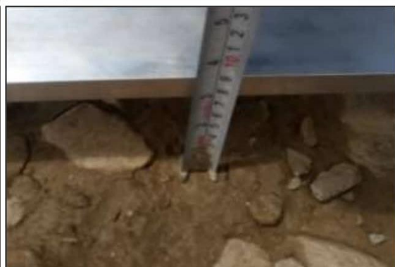
Fotog. Progresiva : 32+287,00 - 32+500,00 132 Se observa que el " BACHRES " Tiene: 7,00 cm Considerado como: NG: 2
