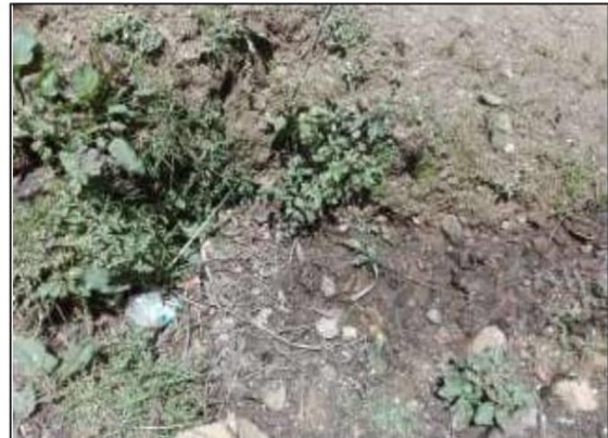
Fotog. Progresiva: 28+165,00 - 28+165,00 44 SALIDA DE LA TAJEA, EN MAL ESTADO ESTRUCTURAL, OBSTRUIDO EN UN 70%
