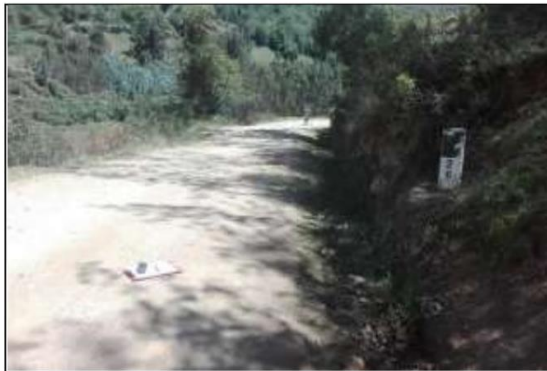
Fotog. Progresiva: 26+048,00 - 26+298,00 21 CUNETA DE TIERRA LADO DERECHO, OBSTRUIDA EN UN 30% ANCHO DE VIA: 3.40M
