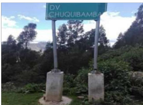
Fotog. Progresiva: 31+776,00 - 31+776,00 77 SEÑAL INFORMATIVA LADO IZQUIERDO, EN MAL ESTADO ESTRUCTURAL, MALA VISIBILIDAD
