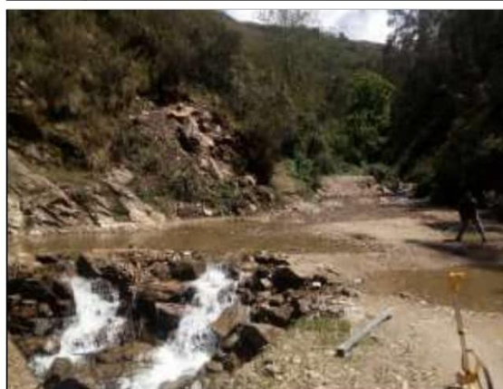
Fotog. Progresiva : 26+385,00 - 26+387,00 47 Se observa la medición del " CRUCE DE AGUA " en el punto más crítico.
