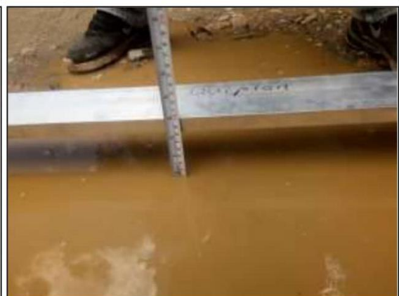
Fotog. Progresiva : 31+145,00 - 31+265,00 114 Se observa que el " BACHRES " Tiene: 9,00 cm Considerado como: NG: 2
