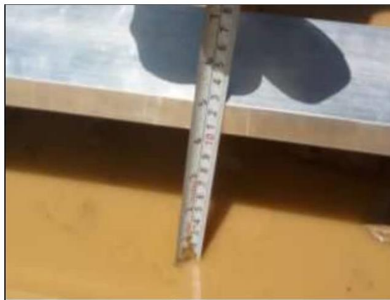
Fotog. Progresiva : 27+500,00 - 27+843,00 75 Se observa que el " BACHRES " Tiene: 10,00 cm Considerado como: NG: 3
