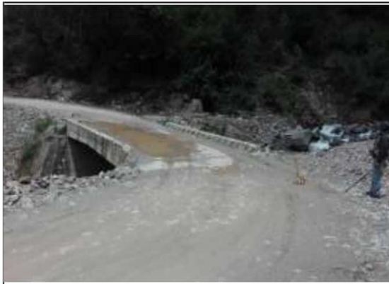
Fotog. 63 Progresiva: 31+134,00 - 31+145,00 PUENTE Nº1 DE VIGA Y LOZA DIMENSIONES: L=11M, A= 4.6M, H= 2.7M
