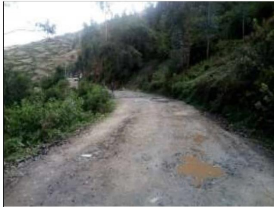
Fotog. 7 Progresiva : 24+166,00 - 24+220,00 Verificación de deterioro o falla de la calzada se observa la existencia de " BACHES ", ancho de plataforma 3.8 m.
