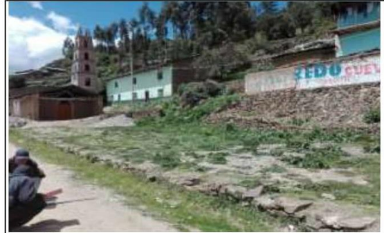
Fotog. Progresiva: 32+720,00 - 32+720,00 104 CUNETETA DE TIERRA LADO DERECHO, OBSTRUIDA EN UN 16% ANCHO DE VIA: 4.90M
