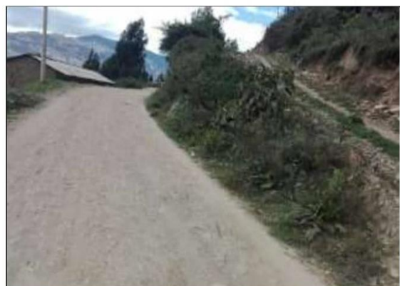
Fotog. Progresiva: 32+005,00 - 32+221,00 96 CUNETA DE TIERRA LADO DERECHO, OBSTRUIDO EN UN 84% ANCHO DE VIA: 3.10M
