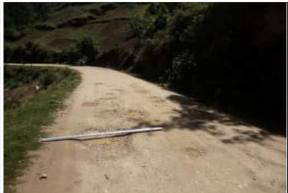
Fotog. Progresiva : 26+000,00 - 26+210,00 40 Verificación de deterioro o falla de la calzada se observa la existencia de " BACHES ", ancho de plataforma 3.8 m.
