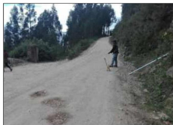
Fotog. Progresiva: 31+776,00 - 31+782,00 78 CUNETETA DE TIERRA LADO DERECHO, OBSTRUIDA EN UN 30% ANCHO DE VIA: 3.60M
