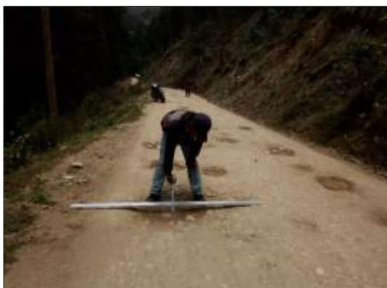
Fotog. Progresiva : 30+500,00 - 30+769,00 101 Se observa la medición del " BACHRES " en el punto más crítico.
