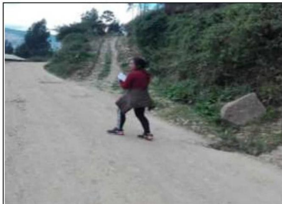
Fotog. Progresiva: 32+000,00 - 32+005,00 93 CUNETA DE TIERRA LADO DERECHO, OBSTRUIDA EN UN 80% ANCHO DE VIA: 3.00M
