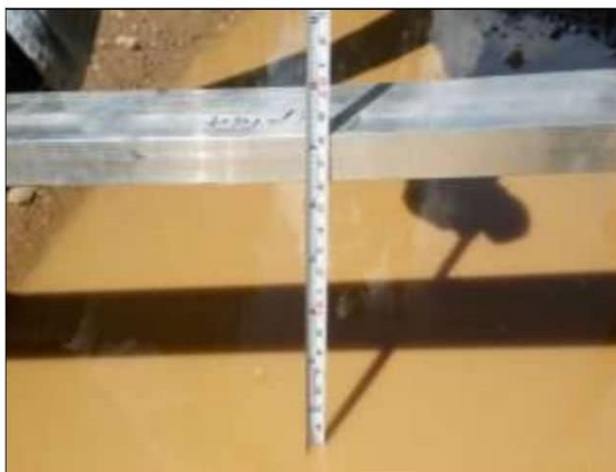
Fotog. Progresiva : 25+500,00 - 25+776,00 33 Se observa que el " BACHES " Tiene: 16,00 cm Considerado como: NG: 3
