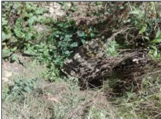
Fotog. Progresiva: 28+165,00 - 28+165,00 43 ENTRADA DE LA TAJERA , EN MAL ESTADO ESTRUCTURAL, OBSTRUIDO EN UN 60%
