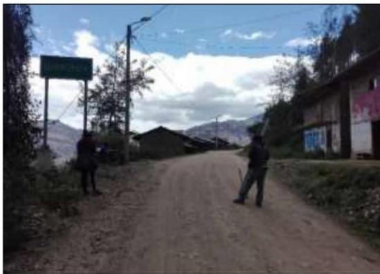
Fotog. Progresiva: 31+944,00 - 32+000,00 89 CUNETA DE TIERRA LADO DERECHO, OBSTRUIDO EN UN 45% ANCHO DE VIA: 3.10M
