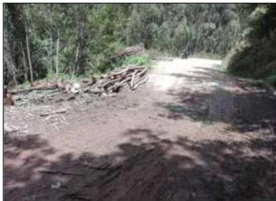
Fotog. Progresiva: 30+614,00 - 30+624,00 57 VISTA AGUAS ABAJO ,BADEN EN MAL ESTADO ESTRUCTURAL, EL AGUA NO CORRE LIBREMENTE.
