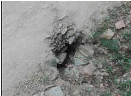
Fotog. Progresiva: 32+000,00 - 32+000,00 91 ENTRADA DE LA TAJEA DE PIEDRA EN MAL ESTADO ESTRUCTURAL OBSTRUIDA POR SEDIMENTOS
