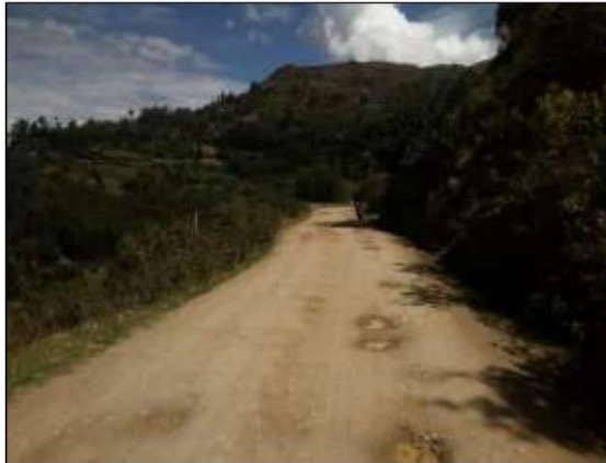
Fotog. Progresiva : 25+500,00 - 25+776,00 31 Verificación de deterioro o falla de la calzada se observa la existencia de " BACHES ", ancho de plataforma 3.2 m.
