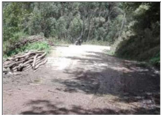
Fotog. Progresiva: 30+624,00 - 31+053,00 58 (INICIO) CUNETTA DE TIERTRA LADO DERECHO, OBSTRUIDA EN UN 80% ANCHO DE VIA 3.40M
