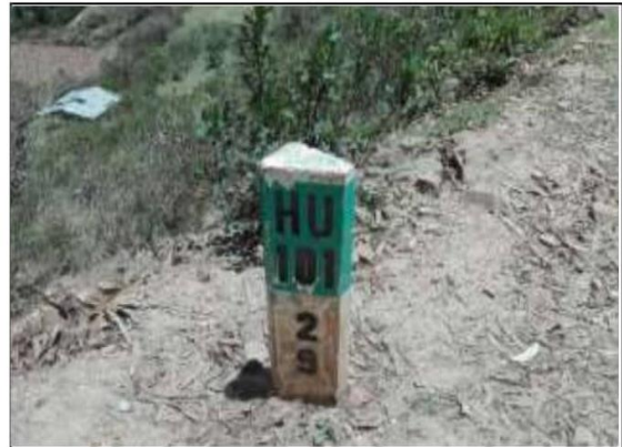
Fotog. Progresiva: 29+071,00 - 29+071,00 46 HITO KILOMETRICO Nº5 LADO IZQUIERDO, BUEN ESTADO ESTRUCTURAL, VISIBILIDAD REGULAR.
