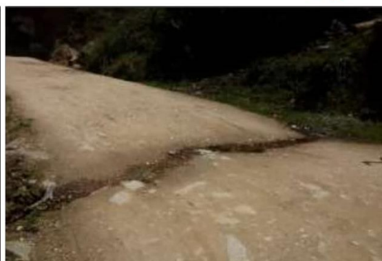
Fotog. Progresiva : 30+769,00 - 30+769,00 104 Se observa la medición del " CRUCE DE AGUA " en el punto más crítico.
