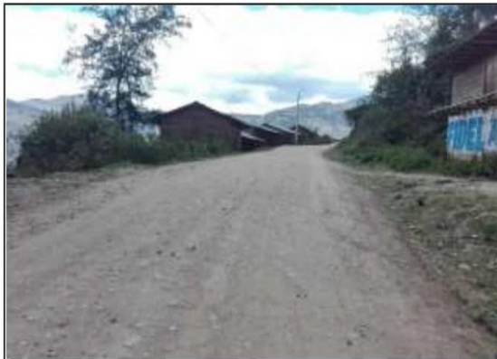
Fotog. Progresiva: 31+944,00 - 31+944,00 87 CUNETA DE TIERRA LADO DERECHO, OBSTRUIDA EN UN 45% ANCHO DE VIA:3.30M
