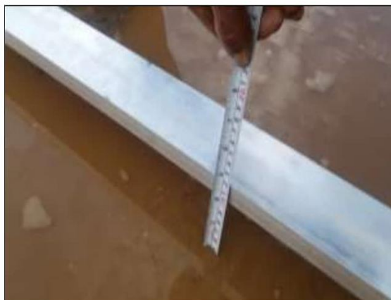
Fotog. Progresiva : 24+223,00 - 24+500,00 15 Se observa que el " BACHES " Tiene: 12,00 cm Considerado como: NG: 3
