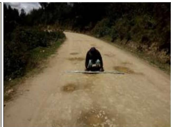
Fotog. Progresiva : 27+006,00 - 27+300,00 64 Verificación de deterioro o falla de la calzada se observa la existencia de " BACHES ", ancho de plataforma 3.58 m.
