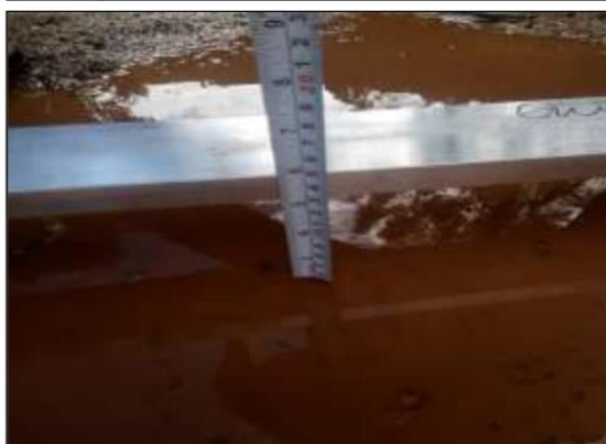
Fotog. Progresiva : 24+133,00 - 24+166,00 6 Se observa que el " LODAZAL " Tiene: 15,00 cm Considerado como: NG: 3
