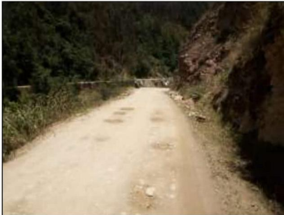
Fotog. Progresiva : 31+000,00 - 31+053,00 109 Verificación de deterioro o falla de la calzada se observa la existencia de " BACHRES ", ancho de plataforma 2.7 m.
