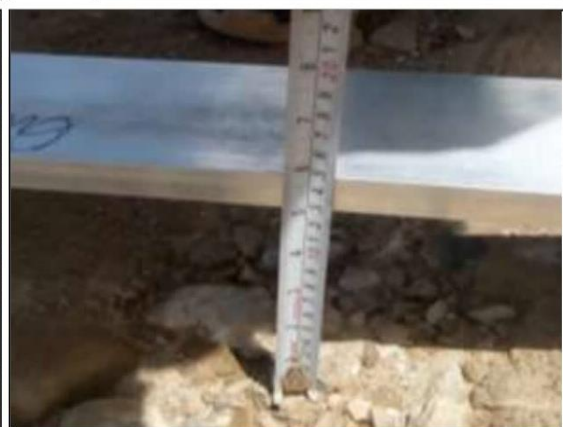
Fotog. Progresiva : 27+843,00 - 28+000,00 78 Se observa que el " EROSIÓN " Tiene: 13,00 cm Considerado como: NG: 3
