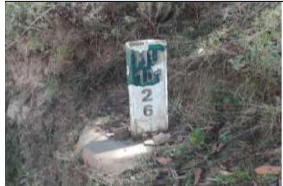
Fotog. Progresiva: 26+048,00 - 26+048,00 20 HITO KILOMETRICO Nº3 EN REGULAR ESTADO ESTRUCTURAL, VISIBILIDAD MALA
