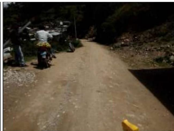
Fotog. Progresiva : 27+843,00 - 28+000,00 76 Verificación de deterioro o falla de la calzada se observa la existencia de " EROSIÓN ", ancho de plataforma 3.57 m.
