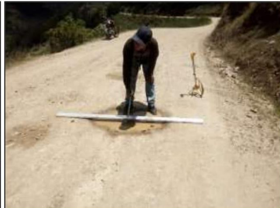
Fotog. Progresiva : 29+000,00 - 29+500,00 92 Se observa la medición del " BACHRES " en el punto más crítico.
