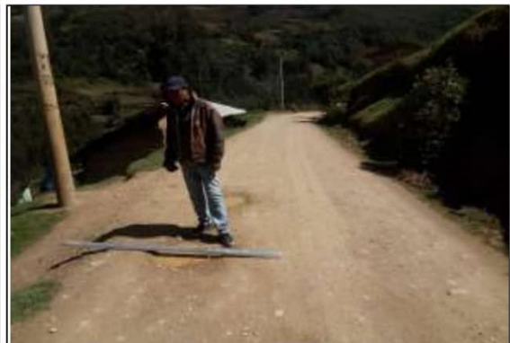
Fotog. Progresiva : 25+780,00 - 25+800,00 38 Se observa la medición del " BACHES " en el punto más crítico.
