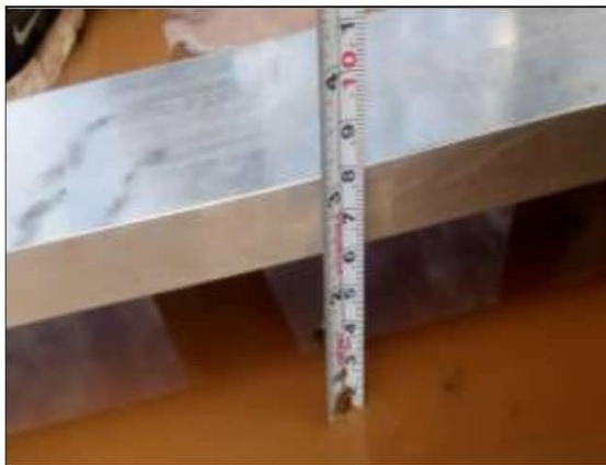
Fotog. Progresiva : 24+710,00 - 25+000,00 27 Se observa que el " BACHES " Tiene: 6,00 cm Considerado como: NG: 2
