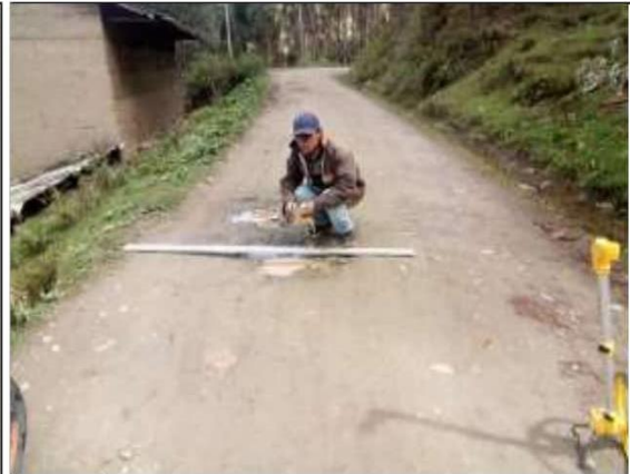
Fotog. Progresiva : 24+514,00 - 24+693,00 20 Se observa la medición del " BACHES " en el punto más crítico.
