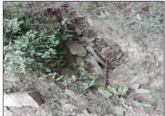
Fotog. Progresiva: 32+063,00 - 32+063,00 98 ENTRADA DE LA TAJEA, EN MAL ESTADO ESTRUCTURAL, OBSTRUIDO.
