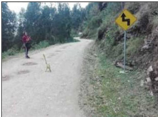
Fotog. Progresiva: 31+494,00 - 31+776,00 75 CUNETETA DE TIERRA LADO DERECHO, OBSTRUIDO EN UN 76% ANCHO=3.10M
