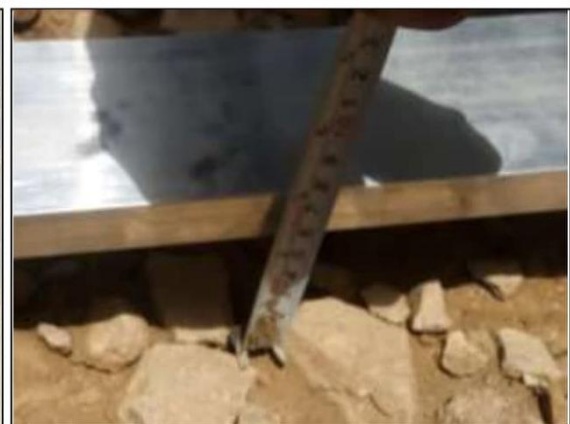
Fotog. Progresiva : 28+520,00 - 29+000,00 90 Se observa que el " BACHRES " Tiene: 6,00 cm Considerado como: NG: 2
