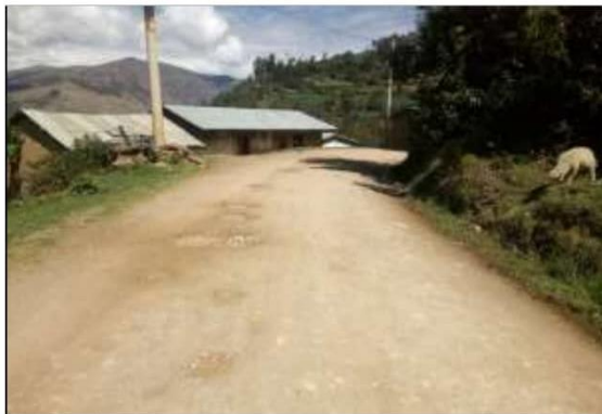
Fotog. Progresiva : 25+780,00 - 25+800,00 37 Verificación de deterioro o falla de la calzada se observa la existencia de " BACHES ", ancho de plataforma 3.3 m.
