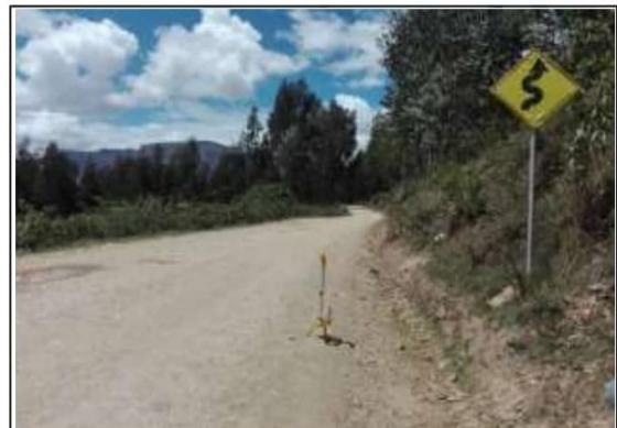
Fotog. 32 Progresiva: 27+152,00 - 27+335,00 CUNETETA DE TIERRA LADO DERECHO, OBSTRUIDO EN UN 15 % ANCHO DE VIA: 3.50M
