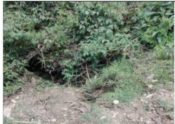
Fotog. 50 Progresiva: 30+024,00 - 30+024,00 SALIDA DE LA TAJEA DE PIEDRA, EN MAL ESTADO ESTRUCTURAL, OBSTRUIDO EN UN 70%
