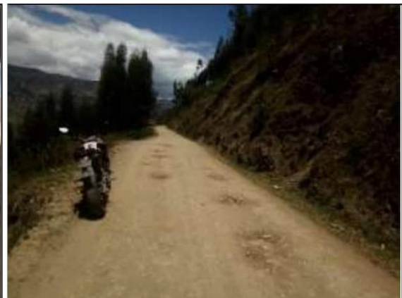
Fotog. Progresiva : 28+520,00 - 29+000,00 88 Verificación de deterioro o falla de la calzada se observa la existencia de " BACHRES ", ancho de plataforma 3.4 m.
