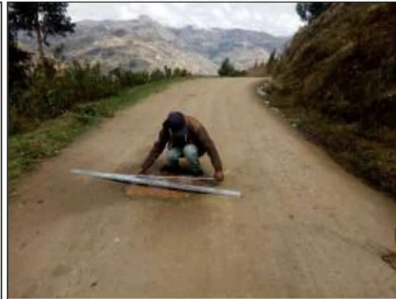
Fotog. Progresiva : 24+710,00 - 25+000,00 26 Se observa la medición del " BACHES " en el punto más crítico.
