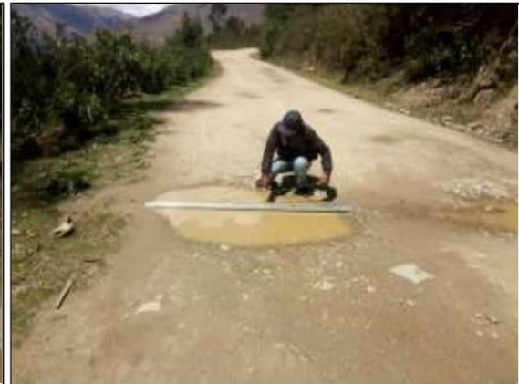
Fotog. Progresiva : 26+643,00 - 26+693,00 62 Se observa la medición del " BACHES " en el punto más crítico.
