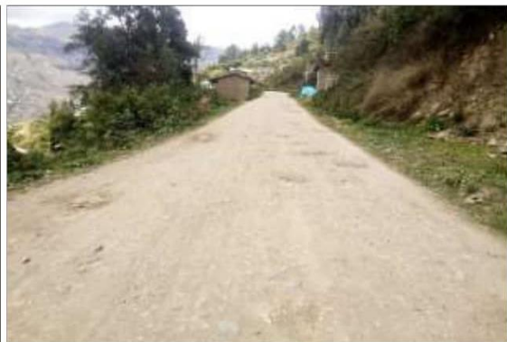
Fotog. Progresiva : 32+287,00 - 32+500,00 130 Verificación de deterioro o falla de la calzada se observa la existencia de " BACHRES ", ancho de plataforma 3.4 m.
