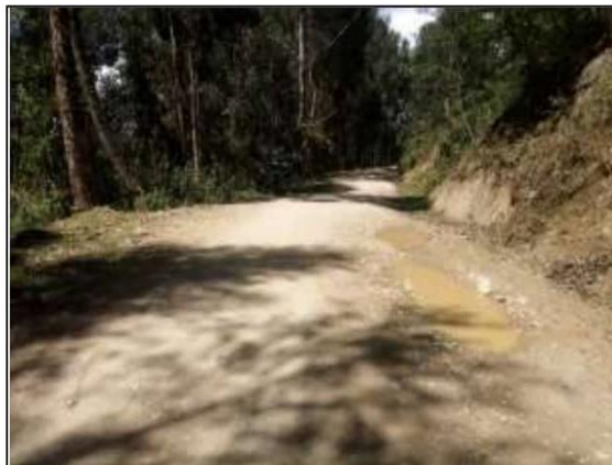
Fotog. Progresiva : 26+510,00 - 26+640,00 55 Verificación de deterioro o falla de la calzada se observa la existencia de " BACHES ", ancho de plataforma 3.1 m.
