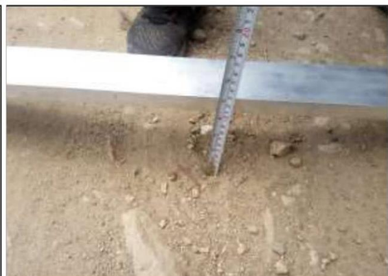
Fotog. Progresiva : 31+789,00 - 31+944,00 126 Se observa que el " EROSION " Tiene: 11,00 cm Considerado como: NG: 3
