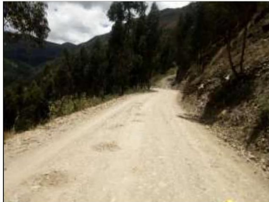
Fotog. Progresiva : 29+000,00 - 29+500,00 91 Verificación de deterioro o falla de la calzada se observa la existencia de " BACHRES ", ancho de plataforma 3.7 m.
