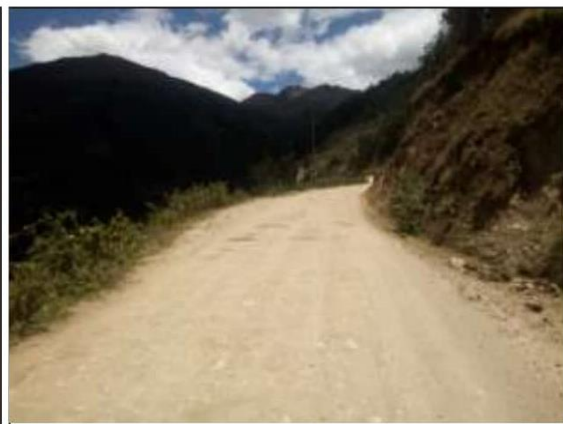
Fotog. Progresiva : 29+500,00 - 30+000,00 94 Verificación de deterioro o falla de la calzada se observa la existencia de " BACHRES ", ancho de plataforma 4.4 m.
