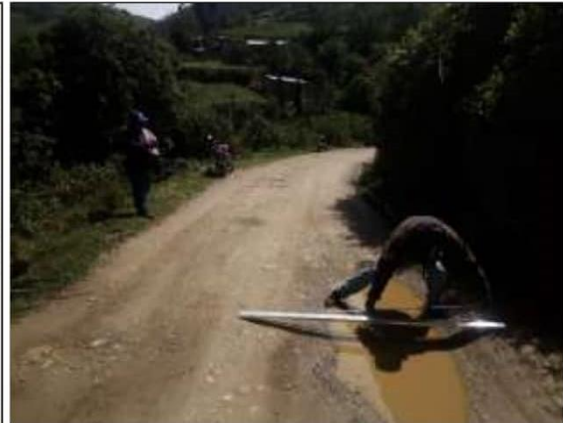
Fotog. Progresiva : 25+500,00 - 25+776,00 32 Se observa la medición del " BACHES " en el punto más crítico.
