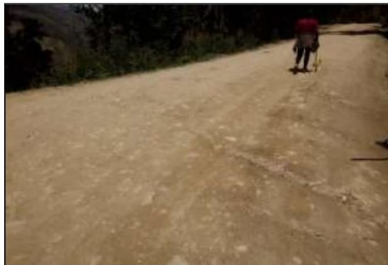
Fotog. Progresiva : 27+335,00 - 27+416,00 67 Verificación de deterioro o falla de la calzada se observa la existencia de " EROSIÓN ", ancho de plataforma 5 m.
