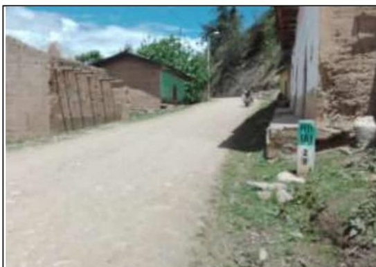
Fotog. Progresiva: 28+086,00 - 29+071,00 41 CUNETETA DE TIERRA LADO DERECHO, OBSTRUIDO EN UN 55% ANCHO DE VIA: 3.00M
