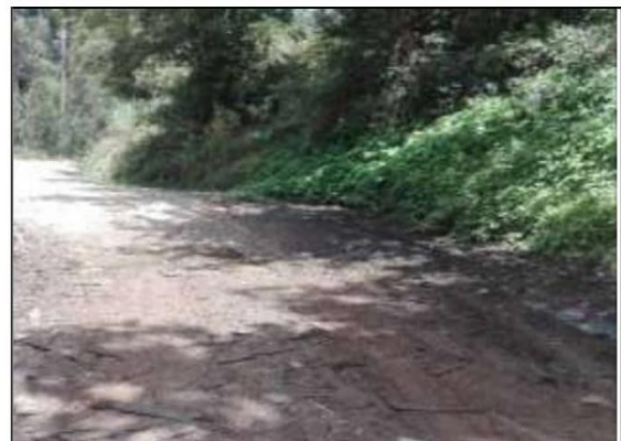
Fotog. 54 Progresiva: 30+614,00 - 30+614,00 (FIN ) DE CUNETA DE TIERRA LADO DERECHO, OBSTRUIDO EN UN 100% ANCHO DE VIA: 3.40M
