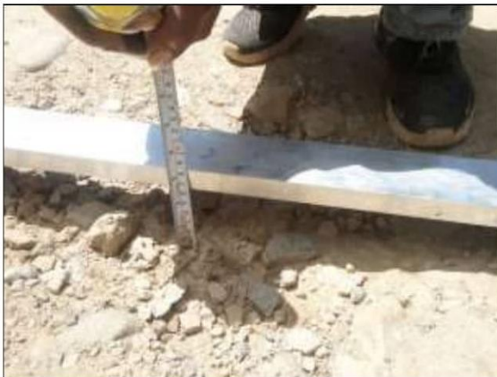
Fotog. Progresiva : 00+000,00 - 00+000,00 135 Se observa que el " BACHRES " Tiene: 7,00 cm Considerado como: NG: 2
