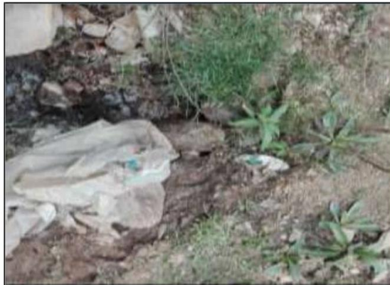
Fotog. 49 Progresiva: 30+024,00 - 30+024,00 ENTRADA DE LA TAJEA DE PIEDRA, EN MAL ESTADO ESTRUCTURAL, OBSTRUIDO EN UN 67%
