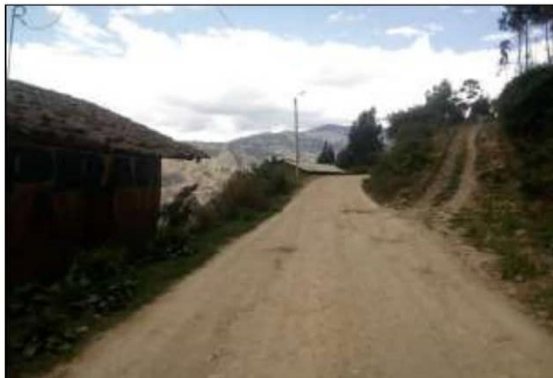
Fotog. Progresiva : 32+000,00 - 32+221,00 127 Verificación de deterioro o falla de la calzada se observa la existencia de " BACHRES ", ancho de plataforma 3.1 m.
