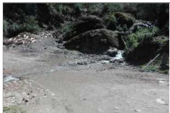
Fotog. Progresiva: 26+298,00 - 28+318,00 24 SE OBSERBA AGUAS ARRIBA LA OBSTRUCCION DE SEDIMENTOS Y LA FALTA DE UN ENBOQUILLADO
