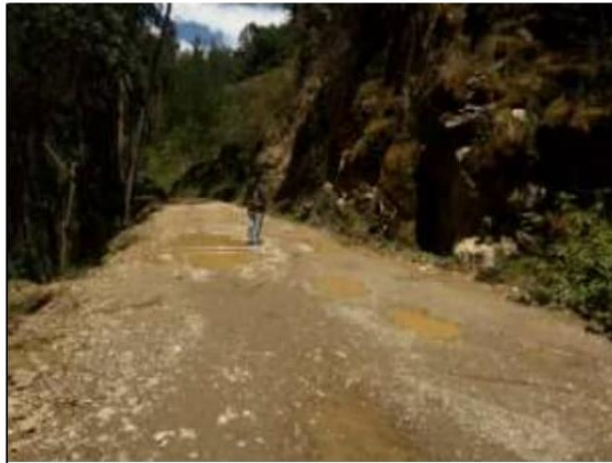
Fotog. Progresiva : 26+390,00 - 26+500,00 49 Verificación de deterioro o falla de la calzada se observa la existencia de " BACHES ", ancho de plataforma 3.5 m.
