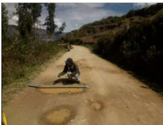
Fotog. Progresiva : 25+000,00 - 25+500,00 29 Se observa la medición del " BACHES " en el punto más crítico.
