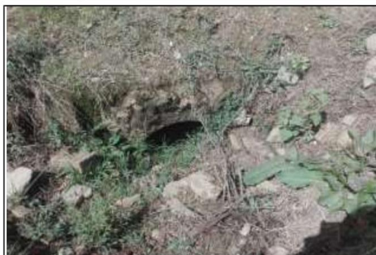
Fotog. Progresiva: 25+210,00 - 25+210,00 17 ENTRADA DE LA ALCANTARILLA SEMIOBSTRUIDA, NO TIENE ALEROS
