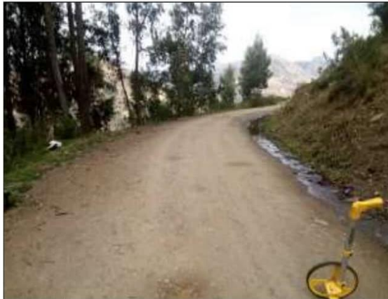
Fotog. Progresiva : 24+710,00 - 25+000,00 25 Verificación de deterioro o falla de la calzada se observa la existencia de " BACHES ", ancho de plataforma 2.8 m.
