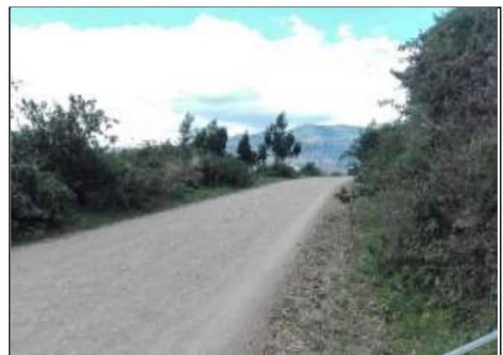
Fotog. Progresiva: 32+221,00 - 32+720,00 102 CUNETA DE TIERRA LADO DERECHO, OBSTRUIDO EN UN 34% ANCHO DE VIA:
