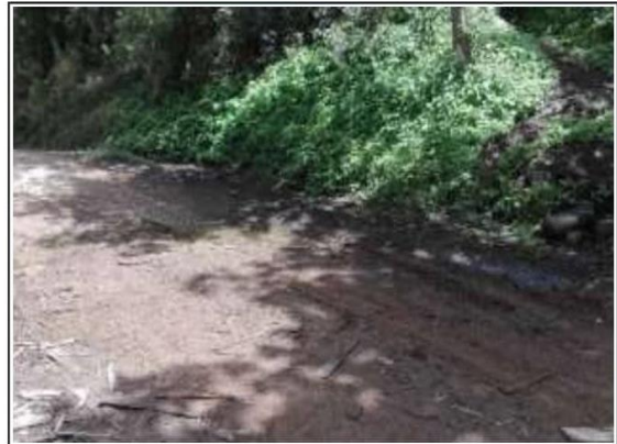
Fotog. Progresiva: 30+614,00 - 30+624,00 56 VISTA AGUAS ARRIBA ,BADEN EN MAL ESTADO ESTRUCTURAL, LOZA DEL BADEN CUBIERTA DE SEDIMENTOS
