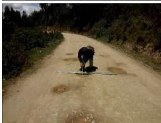
Fotog. Progresiva : 27+006,00 - 27+300,00 65 Se observa la medición del " BACHES " en el punto más crítico.
