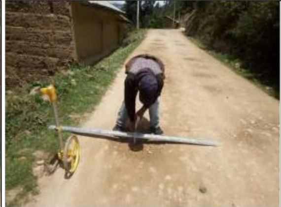
Fotog. Progresiva : 28+165,00 - 28+500,00 86 Se observa la medición del " BACHRES " en el punto más crítico.
