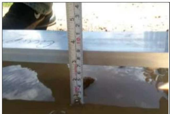
Fotog. Progresiva : 26+000,00 - 26+210,00 42 Se observa que el " BACHES " Tiene: 7,00 cm Considerado como: NG: 2
