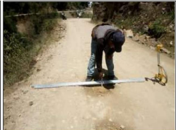
Fotog. Progresiva : 31+000,00 - 31+053,00 110 Se observa la medición del " BACHRES " en el punto más crítico.
