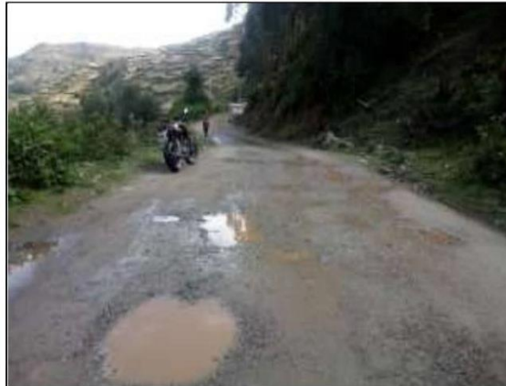
Fotog. Progresiva : 24+223,00 - 24+500,00 13 Verificación de deterioro o falla de la calzada se observa la existencia de " BACHES ", ancho de plataforma 4.8 m.
