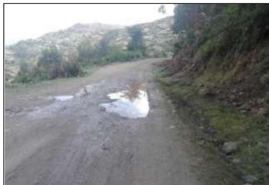
Fotog. Progresiva: 24+229,00 - 25+041,00 5 CUNETETA DE TIERRA LADO DERECHO, OBSTRUIDO EN UN 30% ANCHO DE VIA: 4.50M
