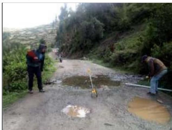
Fotog. 11 Progresiva : 24+220,00 - 24+223,00 Se observa la medición del " CRUCE DE AGUA " en el punto más crítico.
