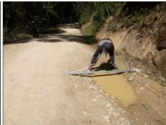
Fotog. Progresiva : 26+510,00 - 26+640,00 56 Se observa la medición del " BACHES " en el punto más crítico.
