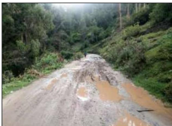
Fotog. Progresiva : 24+133,00 - 24+166,00 4 Verificación de deterioro o falla de la calzada se observa la existencia de " LODAZAL ", ancho de plataforma 4.2 m.
