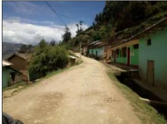
Fotog. Progresiva : 28+000,00 - 28+076,00 79 Verificación de deterioro o falla de la calzada se observa la existencia de " BACHRES ", ancho de plataforma 3.1 m.
