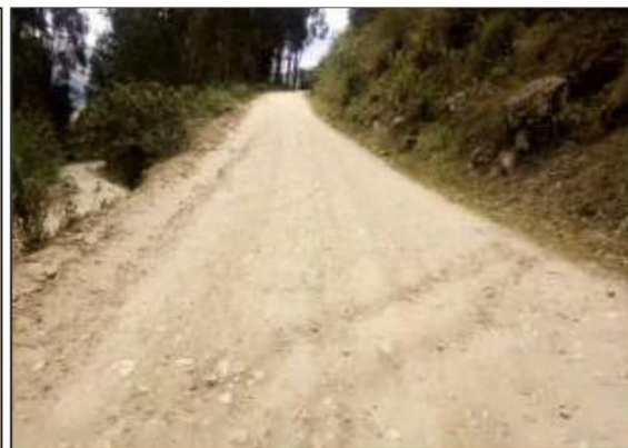
Fotog. Progresiva : 31+789,00 - 31+944,00 124 Verificación de deterioro en la calzada generado por la existencia de " EROSION ", ancho de plataforma 3.3 m.
