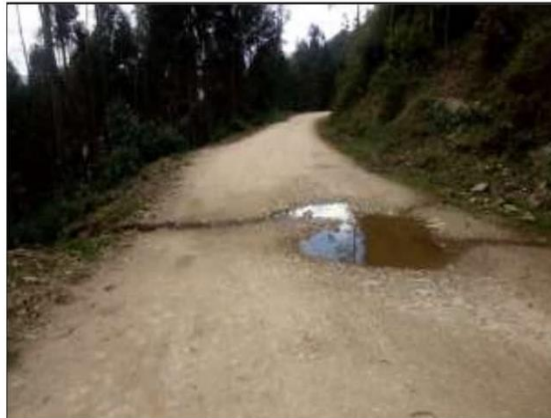
Fotog. Progresiva : 31+275,00 - 31+275,00 115 Verificación de deterioro en la calzada generado por la existencia de " ..... ", ancho de plataforma ..... m.
