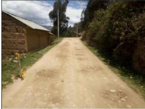
Fotog. Progresiva : 28+165,00 - 28+500,00 85 Verificación de deterioro o falla de la calzada se observa la existencia de " BACHRES ", ancho de plataforma 3.16 m.
