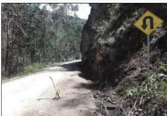
Fotog. Progresiva: 26+403,00 - 27+152,00 29 CUNETETA DE TIERRA LADO DERECHO, OBSTRUIDO EN UN 30 % ANCHO DE VIA: 3.50M
