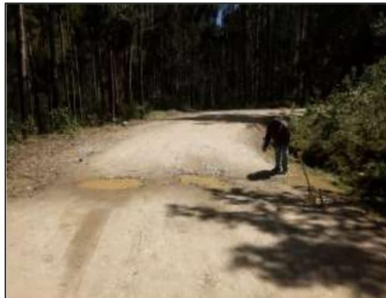
Fotog. Progresiva : 26+215,00 - 26+217,00 43 Verificación de deterioro en la calzada generado por la existencia de " CRUCE DE AGUA ", ancho de plataforma 4.47 m.
