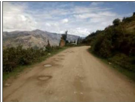
Fotog. Progresiva : 25+000,00 - 25+500,00 28 Verificación de deterioro o falla de la calzada se observa la existencia de " BACHES ", ancho de plataforma 4 m.
