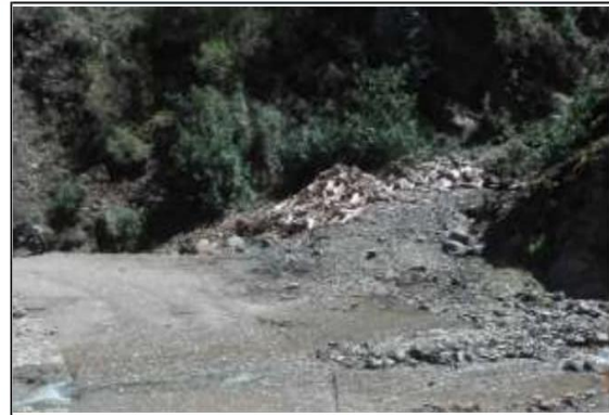
Fotog. Progresiva: 26+298,00 - 26+403,00 26 (INICIO) CUNETETA DE TIERRA LADO DERECHO, OBSTRUIDA EN UN 80 % ANCHO DE VIA: 4.80M
