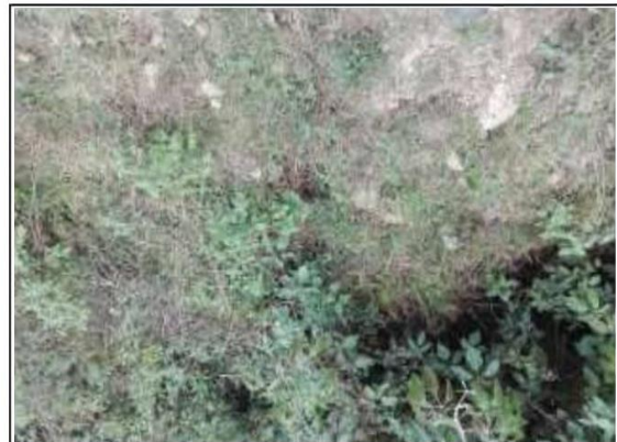
Fotog. Progresiva: 32+000,00 - 32+000,00 92 SALIDA DE LA TAJEA DE PIEDRA EN MAL ESTADO ESTRUCTURAL, OBSTRUIDO POR PLANTAS
