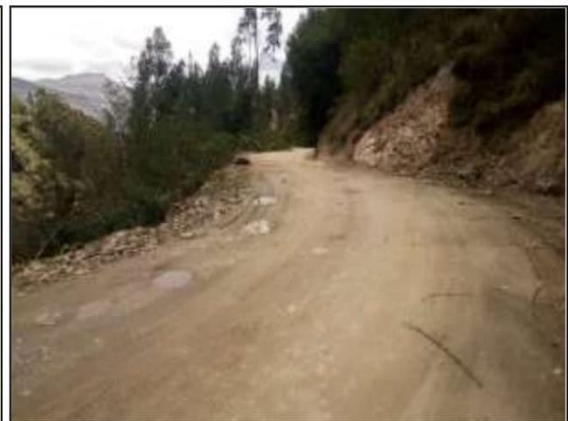
Fotog. Progresiva : 31+145,00 - 31+265,00 112 Verificación de deterioro o falla de la calzada se observa la existencia de " BACHRES ", ancho de plataforma 2.7 m.
