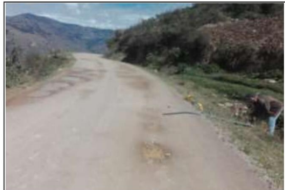
Fotog. Progresiva: 25+210,00 - 25+210,00 16 VISTA PANORAMICA DE ALCANTARILLA Nº1 DE TMC DIMENSIONES: L=3.60M D=0.60M
