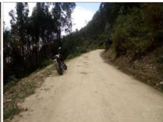
Fotog. Progresiva : 31+270,00 - 31+500,00 118 Verificación de deterioro o falla de la calzada se observa la existencia de " BACHRES ", ancho de plataforma 4 m.
