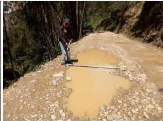
Fotog. Progresiva : 26+390,00 - 26+500,00 50 Se observa la medición del " BACHES " en el punto más crítico.
