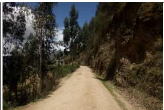
Fotog. Progresiva : 27+416,00 - 27+500,00 70 Verificación de deterioro o falla de la calzada se observa la existencia de " BACHES ", ancho de plataforma 2.84 m.
