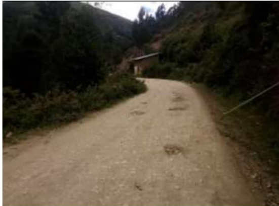
Fotog. Progresiva : 30+000,00 - 30+500,00 97 Verificación de deterioro o falla de la calzada se observa la existencia de " BACHRES ", ancho de plataforma 3.3 m.
