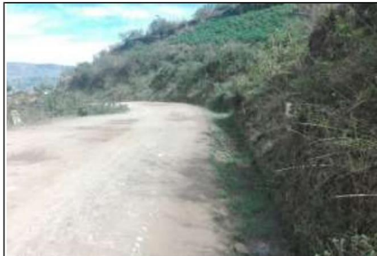
Fotog. Progresiva: 25+042,00 - 26+048,00 15 CUNETA DE TIERRA LADO DERECHO, OBSTRUIDO EN UN 17% ANCHO DE VIA:4.20M
