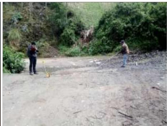
Fotog. Progresiva : 24+693,00 - 24+698,00 22 Verificación de deterioro en la calzada generado por la existencia de " CRUCE DE AGUA ", ancho de plataforma 5.2 m.
