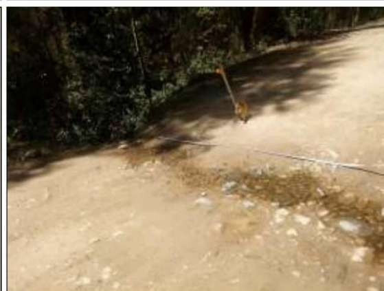
Fotog. Progresiva : 26+642,00 - 26+644,00 60 Se observa que el " CRUCE DE AGUA " Tiene: 7,00 cm Considerado como: NG: 1
