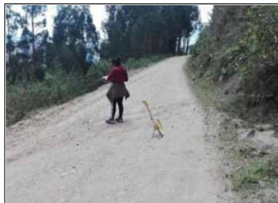
Fotog. Progresiva: 31+786,00 - 31+944,00 84 CUNETA DE TIERRA LADO DERECHO, OBSTRUIDA EN UN 48% ANCHO DE VIA: 3.40M
