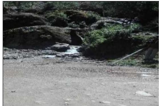
Fotog. Progresiva: 26+298,00 - 26+298,00 22 (FIN) CUNETA DE TIERRA LADO DERECHO, OBSTRUIDA EN UN 38% ANCHO DE VIA: 4.80M
