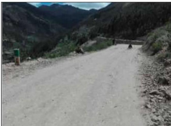
Fotog. Progresiva: 29+071,00 - 30+246,00 47 CUNETA DE TIERRA LADO DERECHO, OBSTRUIDA EN UN 70% ANCHO DE VIA: 3.30M
