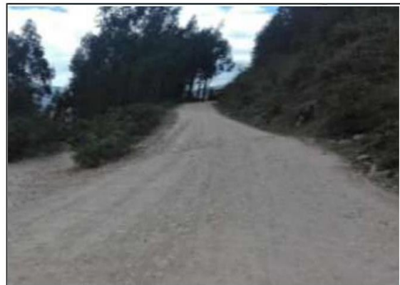
Fotog. Progresiva: 31+782,00 - 31+786,00 80 CUNETA DE TIERRA LADO DERECHO, OBSTRUIDO EN UN 80% ANCHO DE VIA: 3.50M
