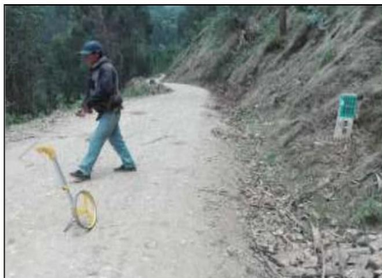
Fotog. 53 Progresiva: 30+246,00 - 30+614,00 CUNETA DE TIERRA LADO DERECHO, OBSTRUIDO EN UN 50% ANCHO DE VIA: 3.50M
