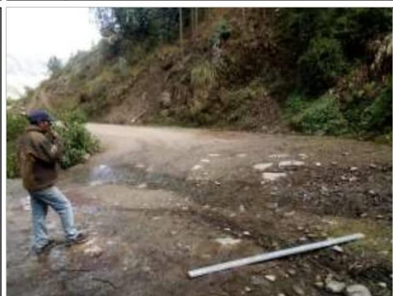
Fotog. Progresiva : 24+693,00 - 24+698,00 24 Se observa que el " CRUCE DE AGUA " Tiene: 0,00 cm Considerado como: NG: 1
