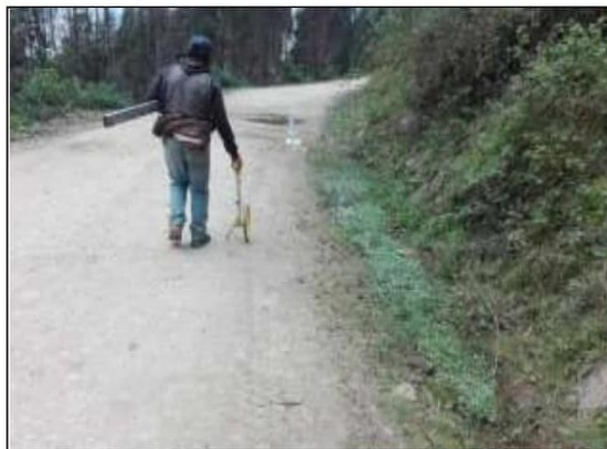
Fotog. Progresiva: 31+250,00 - 31+494,00 69 CUNETETA DE TIERRA LADO DERECHO, OBSTRUIDO EN UN 30 % ANCHO DE VIA : 3.20M
