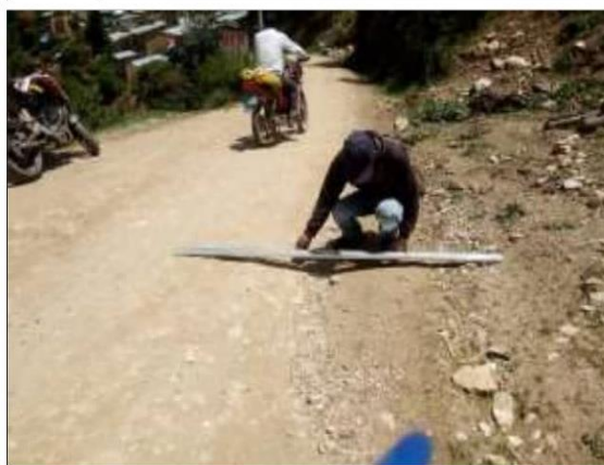
Fotog. Progresiva : 27+843,00 - 28+000,00 77 Se observa la medición del " EROSIÓN " en el punto más crítico.
