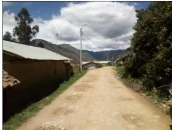
Fotog. Progresiva : 27+500,00 - 27+843,00 73 Verificación de deterioro o falla de la calzada se observa la existencia de " BACHRES ", ancho de plataforma 2.84 m.
