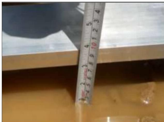
Fotog. Progresiva : 28+000,00 - 28+076,00 81 Se observa que el " BACHRES " Tiene: 7,00 cm Considerado como: NG: 2
