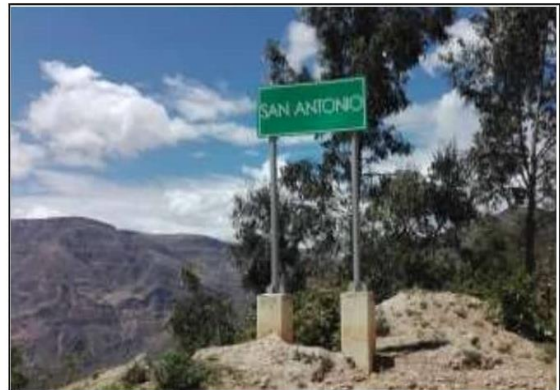
Fotog. 34 Progresiva: 27+335,00 - 27+335,00 SEÑAL INFORMATIVA Nº1 LADO IZQUIERDO, EN BUEN ESTADO ESTRUCTURAL, BUENA VISIBILIDAD.
