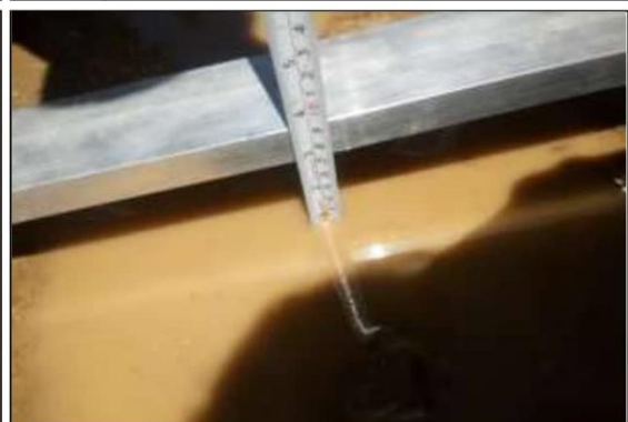
Fotog. Progresiva : 27+416,00 - 27+500,00 72 Se observa que el " BACHES " Tiene: 7,00 cm Considerado como: NG: 2
