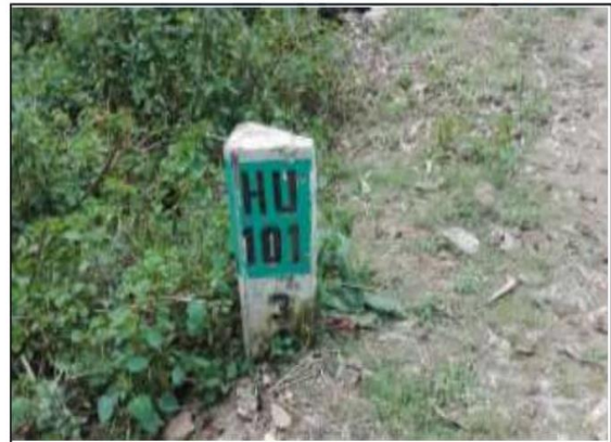
Fotog. Progresiva: 31+250,00 - 31+250,00 68 HITO KILOMETRICO N°7 LADO IZQUIERDO, EN REGULAR ESTADO ESTRUCTURAL, VISIBILIDAD MALA.
