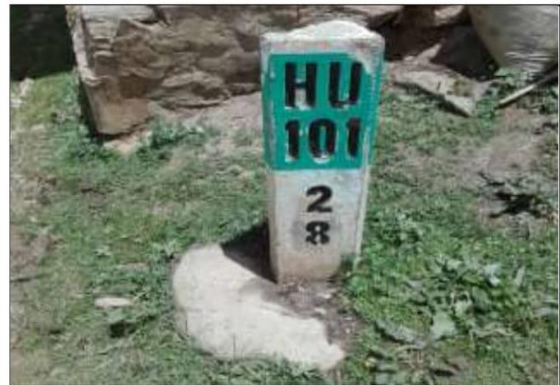
Fotog. Progresiva: 28+086,00 - 28+086,00 40 HITO KILOMETRICO Nº4 LADO DERECHO, BUEN ESTADO ESTRUCTURAL, VISIBILIDAD REGULAR.
