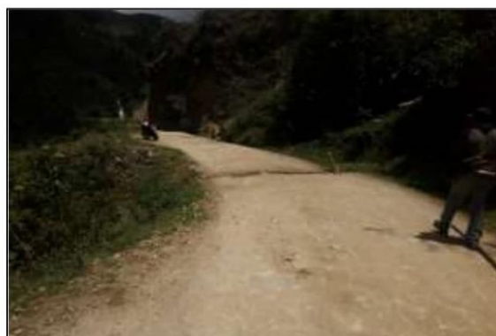
Fotog. Progresiva : 30+769,00 - 30+769,00 103 Verificación de deterioro en la calzada generado por la existencia de " CRUCE DE AGUA ", ancho de plataforma 3.5 m.
