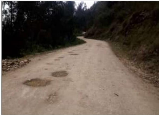
Fotog. Progresiva : 31+500,00 - 31+780,00 121 Verificación de deterioro o falla de la calzada se observa la existencia de " BACHRES ", ancho de plataforma 2.89 m.
