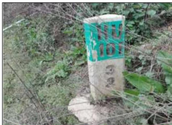
Fotog. Progresiva: 32+221,00 - 32+221,00 101 HITO KILOMETRICO Nº18 AL LADO DERECHO, EN REGULAR ESTADO ESTRUCTURAL, VISIBILIDAD MALA.
