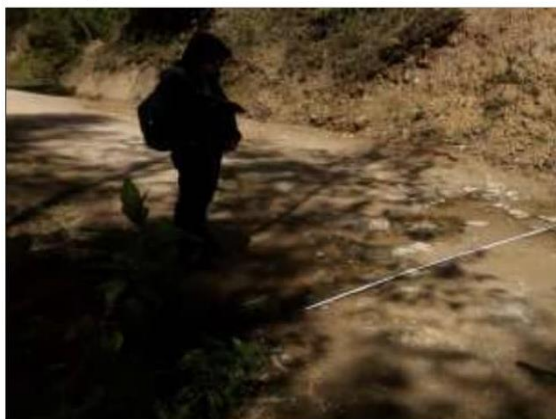
Fotog. Progresiva : 26+500,00 - 26+502,00 53 Se observa la medición del " CRUCE DE AGUA " en el punto más crítico.
