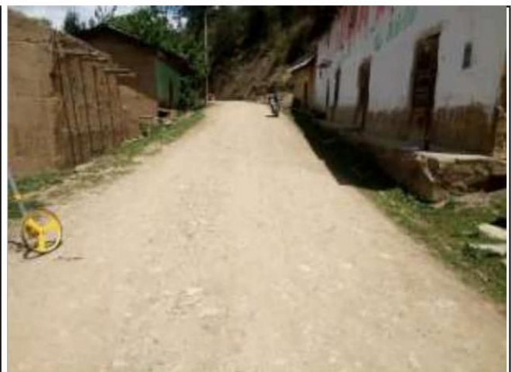
Fotog. Progresiva : 28+076,00 - 28+165,00 82 Verificación de deterioro o falla de la calzada se observa la existencia de " EROSIÓN ", ancho de plataforma 2.9 m.
