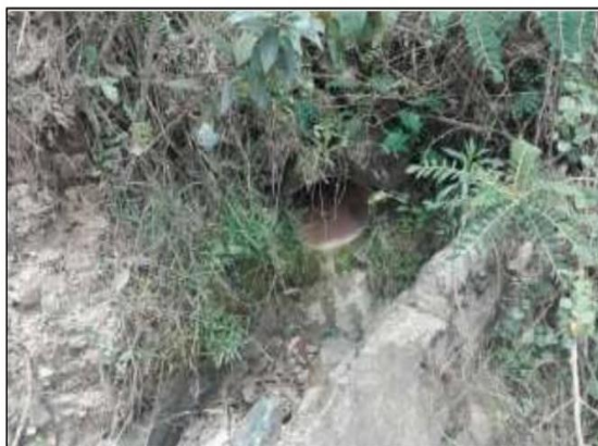
Fotog. Progresiva: 31+786,00 - 31+786,00 83 SALIDA DE LA TAJEA, EN REGULAR ESTADO ESTRUCTURAL. SEMI OBSTRUIDO.
