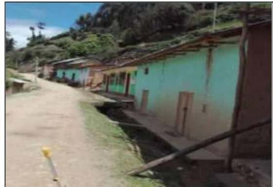
Fotog. Progresiva: 28+000,00 - 28+086,00 38 CUNETETA DE TIERRA LADO DERECHO, OBSTRUIDA EN UN 26% ANCHO DE VIA: 3.00M
