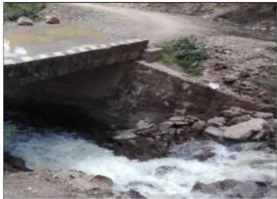
Fotog. 66 Progresiva: 31+145,00 - 31+250,00 (INICIO) CUNETETA DE TIERRA LADO DERECHO, OBSTRUIDO EN UN 70% ANCHO DE VIA: 4.60M
