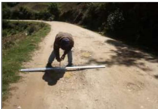
Fotog. Progresiva : 26+000,00 - 26+210,00 41 Se observa la medición del " BACHES " en el punto más crítico.
