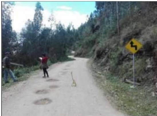
Fotog. Progresiva: 31+494,00 - 31+494,00 73 SEÑAL PREVENTIVA Nº3 LADO DERECHO ANCHO VIA: 3.10M
