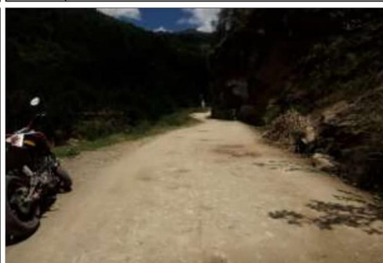
Fotog. Progresiva : 30+769,00 - 31+000,00 106 Verificación de deterioro o falla de la calzada se observa la existencia de " BACHRES ", ancho de plataforma 2.5 m.
