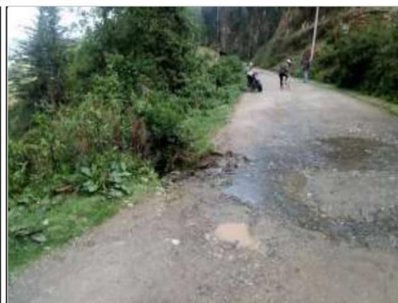
Fotog. Progresiva : 24+505,00 - 24+514,00 18 Se observa que el " CRUCE DE AGUA " Tiene: 0,00 cm Considerado como: NG: 1
