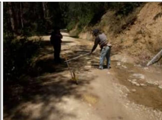
Fotog. Progresiva : 26+500,00 - 26+502,00 52 Verificación de deterioro en la calzada generado por la existencia de " CRUCE DE AGUA ", ancho de plataforma 5.6 m.
