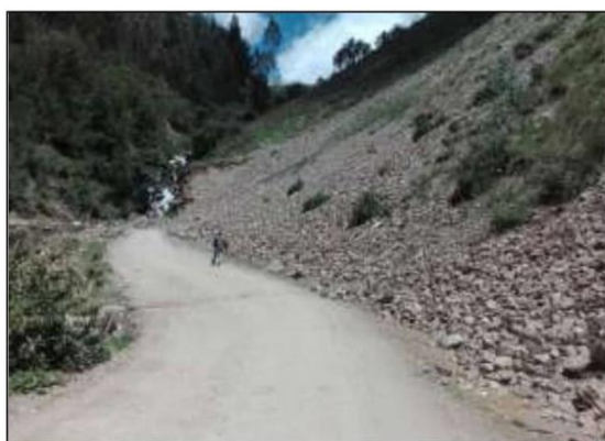
Fotog. Progresiva: 31+053,00 - 31+053,00 59 PUNTO CRITICO Nº1 DESLIZAMIENTO DEL TALUD SUPERIOR.
