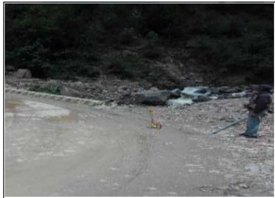
Fotog. 62 Progresiva: 31+134,00 - 31+134,00 (FIN) CUNETETA DE TIERRA LADO DERECHO, OBSTRUIDA EN UN 85% ANCHO DE VIA: 4.6M
