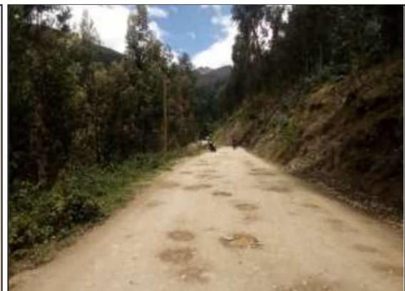
Fotog. Progresiva : 30+500,00 - 30+769,00 100 Verificación de deterioro o falla de la calzada se observa la existencia de " BACHRES ", ancho de plataforma 2.57 m.
