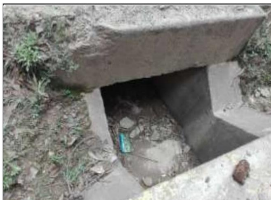
Fotog. Progresiva: 31+489,00 - 31+489,00 71 ENTRADA DE LA ALCANTARILLA, EN REGULAR ESTADO ESTRUCTURAL, OBSTRUIDA, NO TIENE ALEROS,
