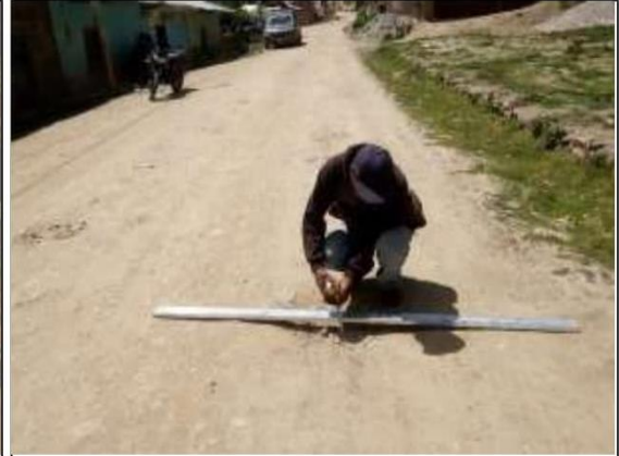
Fotog. Progresiva : 00+000,00 - 00+000,00 134 Se observa la medición del " BACHRES " en el punto más crítico.
