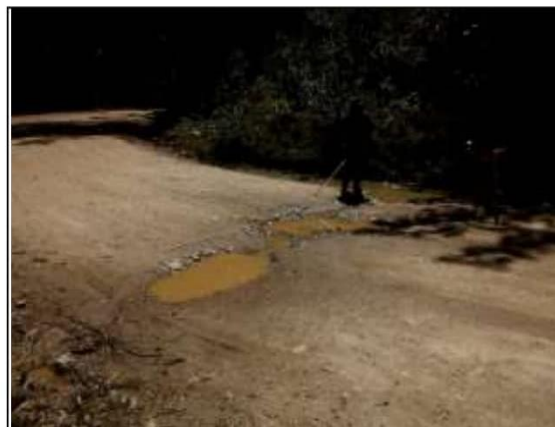
Fotog. Progresiva : 26+215,00 - 26+217,00 45 Se observa que el " CRUCE DE AGUA " Tiene: 0,00 cm Considerado como: NG: 1
