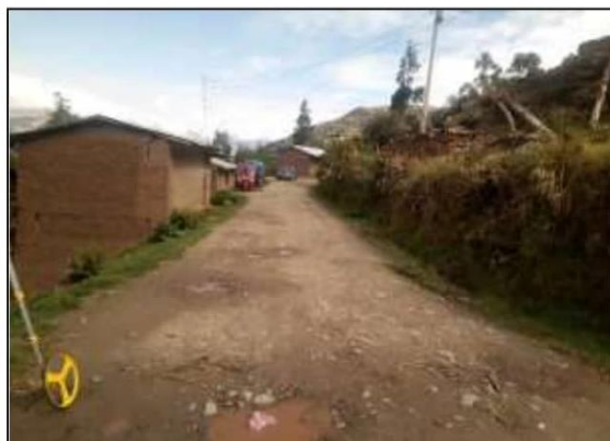
Fotog. Progresiva : 24+046,00 - 24+133,00 1 Verificación de deterioro o falla de la calzada se observa la existencia de " BACHES ", ancho de plataforma 3.9 m.
