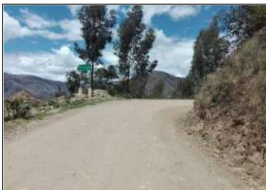
Fotog. 35 Progresiva: 27+335,00 - 27+500,00 CUNETETA DE TIERRA LADO DERECHO, OBSTRUIDA EN UN 10% ANCHO DE VIA: 5.00M
