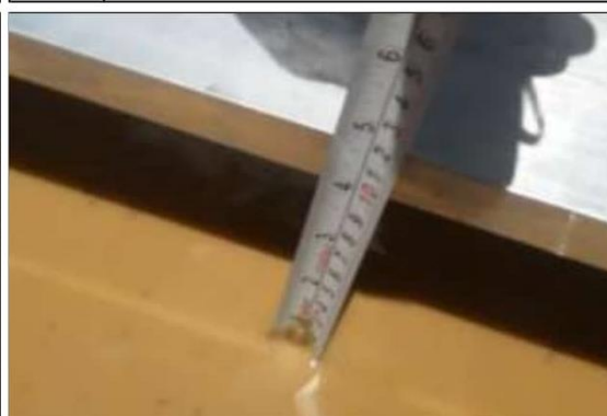
Fotog. Progresiva : 30+769,00 - 31+000,00 108 Se observa que el " BACHRES " Tiene: 10,00 cm Considerado como: NG: 3
