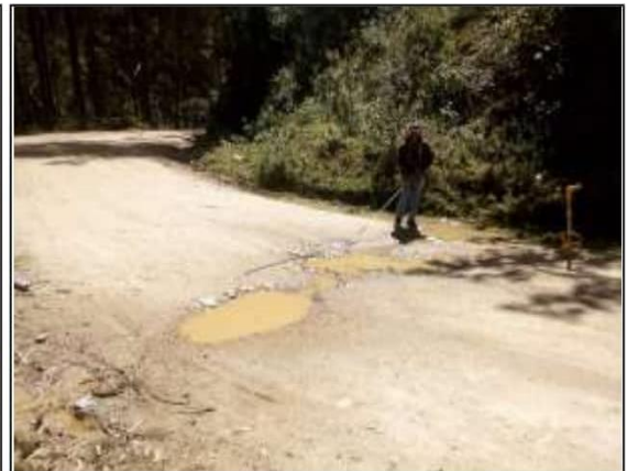
Fotog. Progresiva : 26+215,00 - 26+217,00 44 Se observa la medición del " CRUCE DE AGUA " en el punto más crítico.
