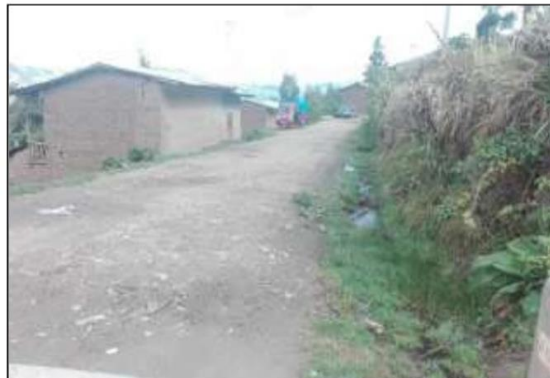
Fotog. Progresiva: 24+046,00 - 24+229,00 3 CUNETETA DE TIERRA LADO DERECHO OBSTRUIDA EN UN 20% ANCHO DE VIA: 3.90M
