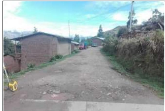
Fotog. Progresiva: 24+046,00 - 24+046,00 2 (INICIO) CUNETETA DE TIERRA LADO DERECHO OBSTRUIDA EN UN 10% ANCHO DE VIA: 3.9M
