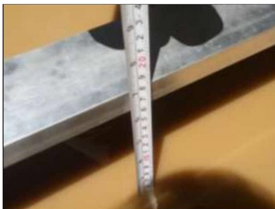
Fotog. Progresiva : 26+510,00 - 26+640,00 57 Se observa que el " BACHES " Tiene: 10,00 cm Considerado como: NG: 3
