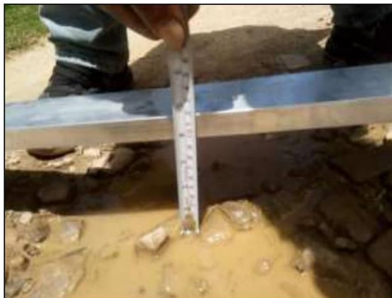
Fotog. Progresiva : 28+165,00 - 28+500,00 87 Se observa que el " BACHRES " Tiene: 10,00 cm Considerado como: NG: 2
