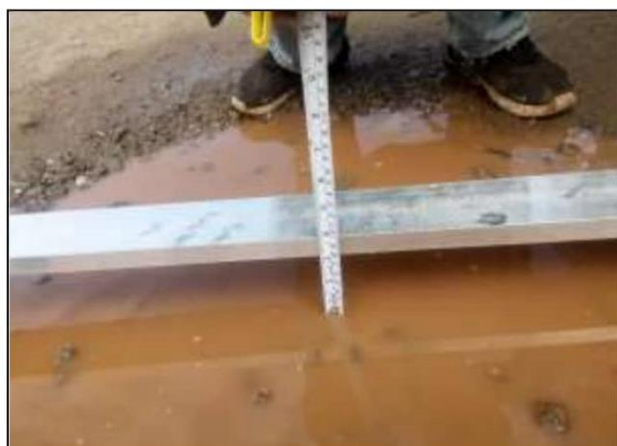
Fotog. Progresiva : 24+046,00 - 24+133,00 3 Se observa que el " BACHES " Tiene: 10,00 cm Considerado como: NG: 2
