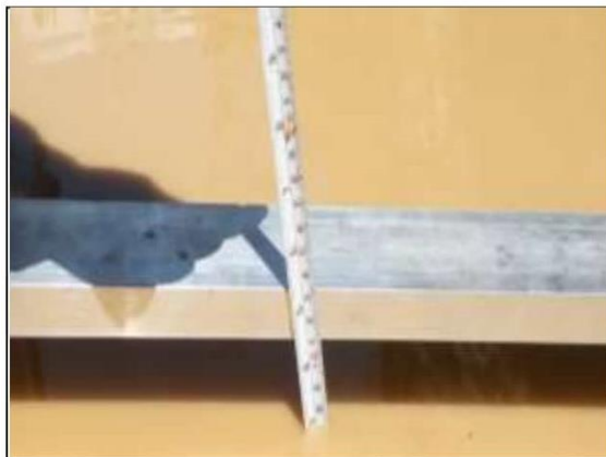
Fotog. Progresiva : 26+390,00 - 26+500,00 51 Se observa que el " BACHES " Tiene: 10,00 cm Considerado como: NG: 3
