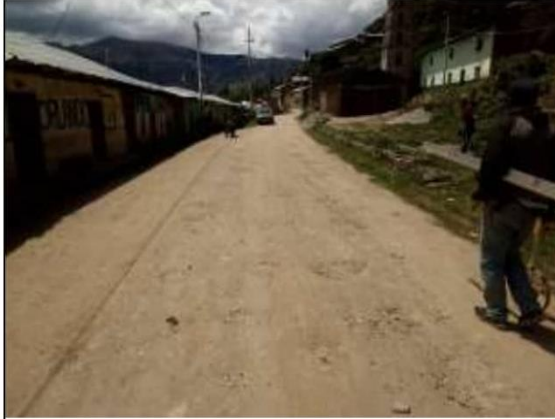
Fotog. Progresiva : 00+000,00 - 0+000,00 133 Verificación de deterioro o falla de la calzada se observa la existencia de " BACHRES ", ancho de plataforma 3.57 m.
