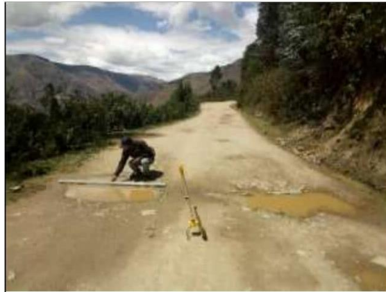
Fotog. Progresiva : 26+643,00 - 26+693,00 61 Verificación de deterioro o falla de la calzada se observa la existencia de " BACHES ", ancho de plataforma 4.4 m.
