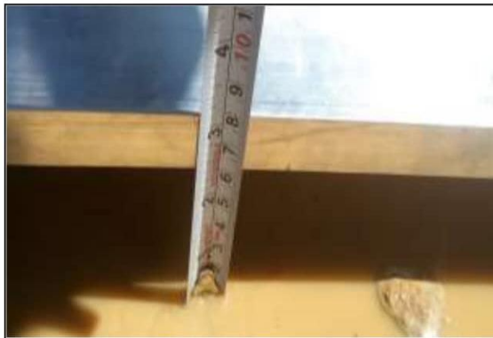
Fotog. Progresiva : 25+780,00 - 25+800,00 39 Se observa que el " BACHES " Tiene: 7,00 cm Considerado como: NG: 2
