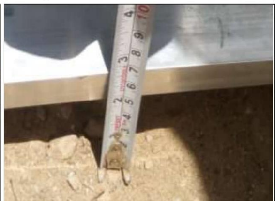
Fotog. Progresiva : 28+076,00 - 28+165,00 84 Se observa que el " EROSIÓN " Tiene: 5,00 cm Considerado como: NG: 1
