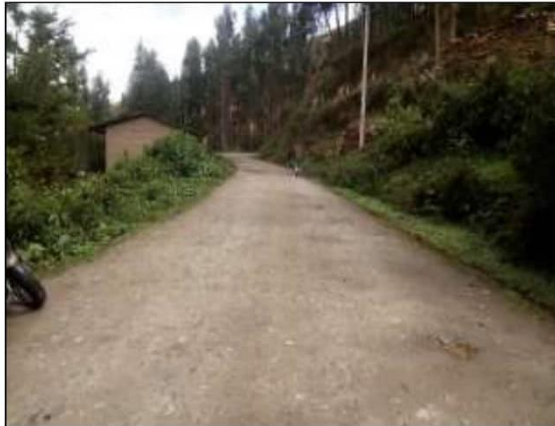
Fotog. Progresiva : 24+514,00 - 24+693,00 19 Verificación de deterioro o falla de la calzada se observa la existencia de " BACHES ", ancho de plataforma 4.2 m.
