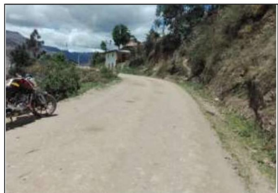
Fotog. 36 Progresiva: 27+500,00 - 28+000,00 CUNETETA DE TIERRA LADO DERECHO, OBSTRUIDA EN UN 18% ANCHO DE VIA: 3.60M
