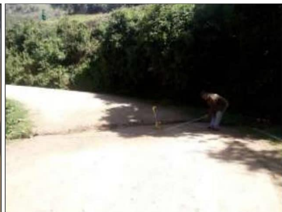
Fotog. Progresiva : 25+776,00 - 25+780,00 34 Verificación de deterioro en la calzada generado por la existencia de " CRUCE DE AGUA ", ancho de plataforma 4.5 m.
