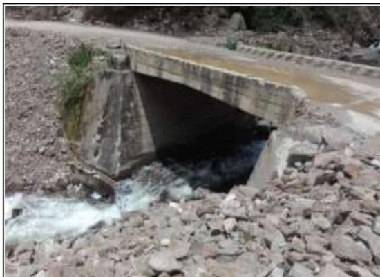
Fotog. 65 Progresiva: 31+134,00 - 31+145,00 VISTA AGUAS ABAJO, LOZA EN REGULAR ESTADO ESTRUCTURAL.
