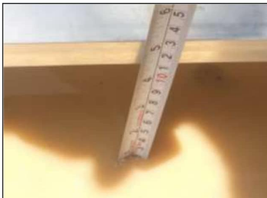
Fotog. Progresiva : 30+000,00 - 30+500,00 99 Se observa que el " BACHRES " Tiene: 9,00 cm Considerado como: NG: 2
