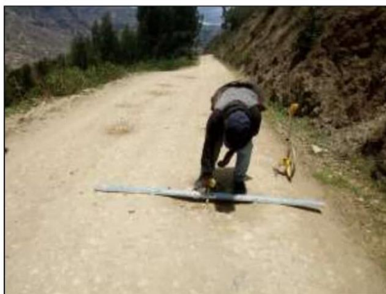
Fotog. Progresiva : 28+520,00 - 29+000,00 89 Se observa la medición del " BACHRES " en el punto más crítico.
