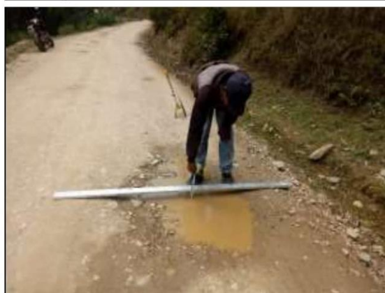
Fotog. Progresiva : 31+270,00 - 31+500,00 119 Se observa la medición del " BACHRES " en el punto más crítico.
