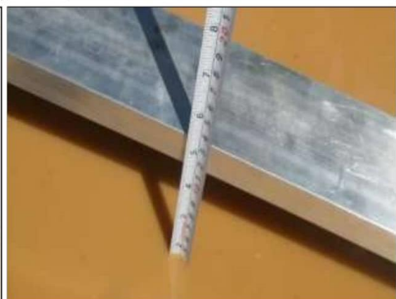
Fotog. Progresiva : 25+000,00 - 25+500,00 30 Se observa que el " BACHES " Tiene: 11,00 cm Considerado como: NG: 3
