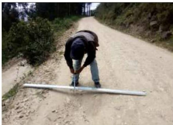
Fotog. Progresiva : 31+789,00 - 31+944,00 125 Se observa la medición del " EROSION " en el punto más crítico.
