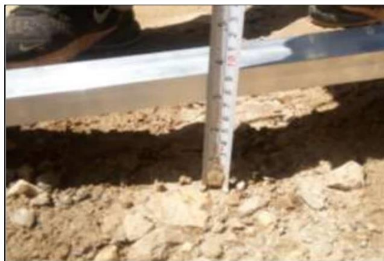
Fotog. Progresiva : 27+335,00 - 27+416,00 69 Se observa que el " EROSIÓN " Tiene: 8,00 cm Considerado como: NG: 2
