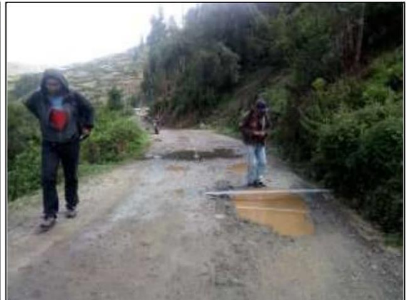
Fotog. 8 Progresiva : 24+166,00 - 24+220,00 Se observa la medición del " BACHES " en el punto más crítico.
