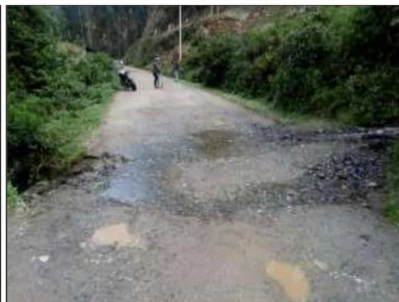
Fotog. Progresiva : 24+505,00 - 24+514,00 16 Verificación de deterioro en la calzada generado por la existencia de " CRUCE DE AGUA ", ancho de plataforma 4.5 m.
