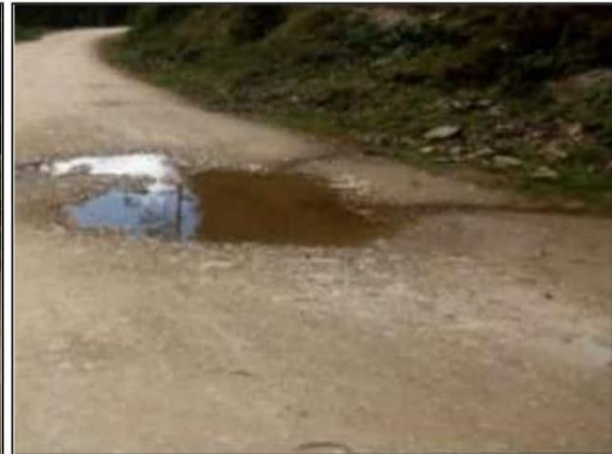
Fotog. Progresiva : 31+275,00 - 31+275,00 116 Se observa la medición del " ..... " en el punto más crítico.
