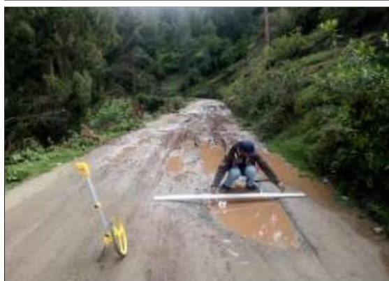
Fotog. Progresiva : 24+133,00 - 24+166,00 5 Se observa la medición del " LODAZAL " en el punto más crítico.
