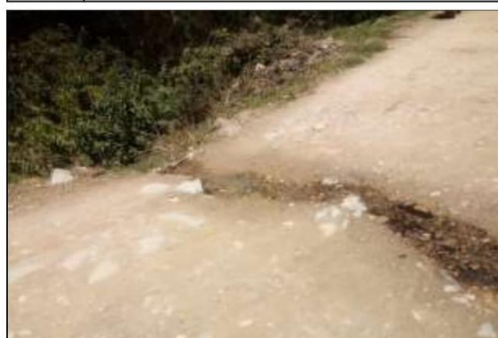
Fotog. Progresiva : 30+769,00 - 30+769,00 105 Se observa que el " CRUCE DE AGUA " Tiene: Considerado como: NG:
