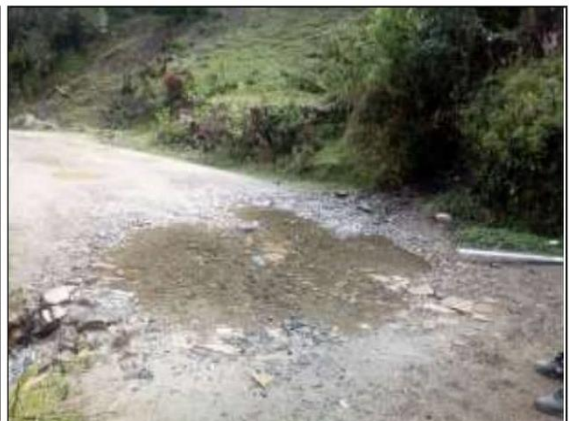
Fotog. 10 Progresiva : 24+220,00 - 24+223,00 Verificación de deterioro en la calzada generado por la existencia de " CRUCE DE AGUA ", ancho de plataforma 3 m.
