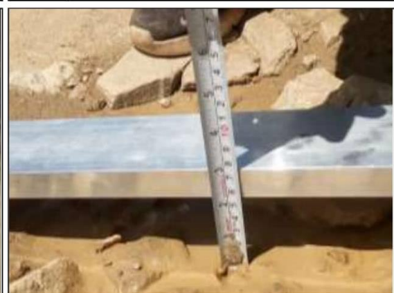
Fotog. Progresiva : 27+006,00 - 27+300,00 66 Se observa que el " BACHES " Tiene: 6,00 cm Considerado como: NG: 2
