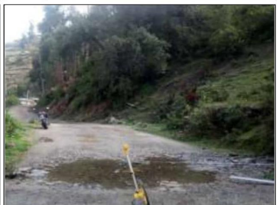
Fotog. 12 Progresiva : 24+220,00 - 24+223,00 Se observa que el " CRUCE DE AGUA " Tiene: 300,00 cm Considerado como: NG: 1
