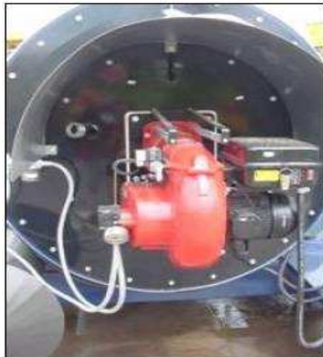
Ilustración 29: Calderas que operan en la Planta "Ciudad"
