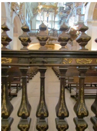
Figura 42 – Balastrada do Mosteiro de São Martinho de Tibães, Pormenor do fecho – (Imagem do autor)
