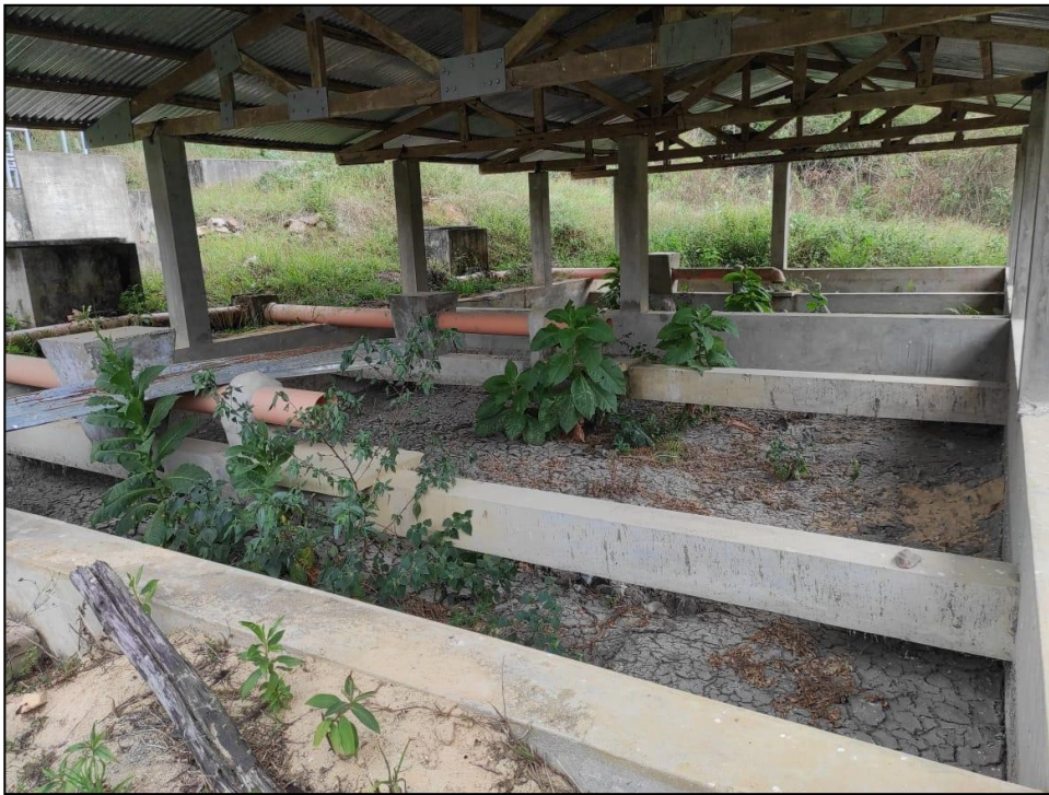
Fotografía 6.7: Lecho de secados del sistema de la PTAR inoperativo .
