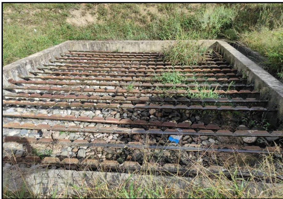
Fotografía 12: Filtro biológico no operative al 100%
