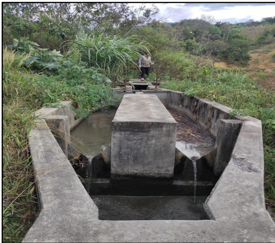
Fotografía 10: Planta de tratamiento preliminar, desarenadores.
