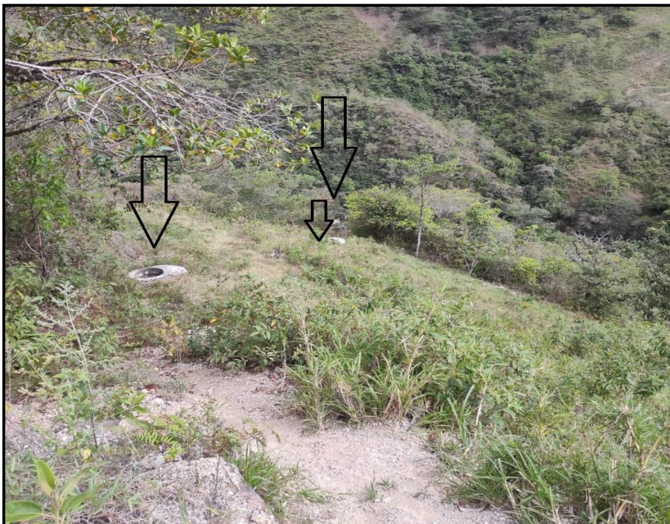
FOTOGRAFÍA 9: Buzones en pésimas condiciones que llevan el fluido a la PTAR .
