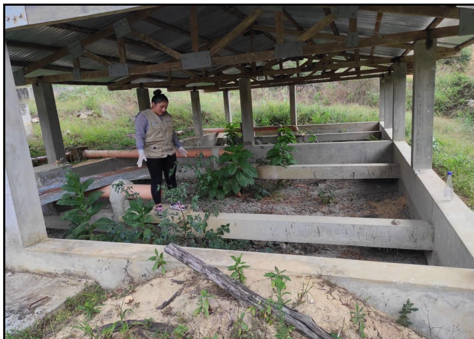
Fotografía 11: Lecho de secado de la PTAR inoperable.
