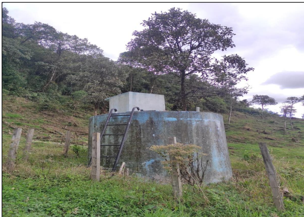
Fotografía 6.2 : Reservorio de 45 m3 del distrito Santo Domingo de la Capilla
