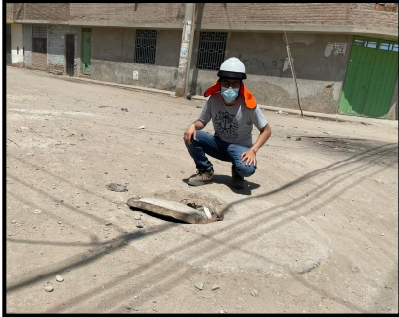
Ilustración 45. Situación actual de uno de los buzones del P.J. Santa Ana sector 1 (Intersección entre las calles Jorge Chávez y Antenor Orrego)
