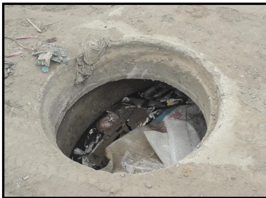
Ilustración 44. Buzón colmatado y ubicado en la calle San Felipe
