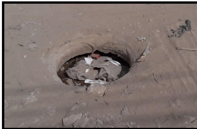
Ilustración 42. Buzón colmatado y ubicado entre de las calles San Felipe y Panamá
