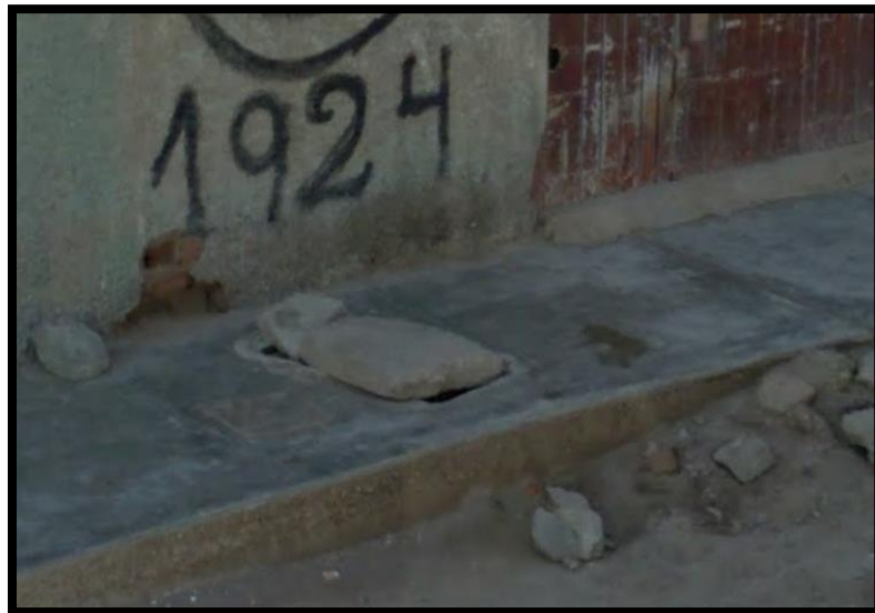
Ilustración 48. Conexión Domiciliaria de Alcantarillado que tiene una piedra como tapa
