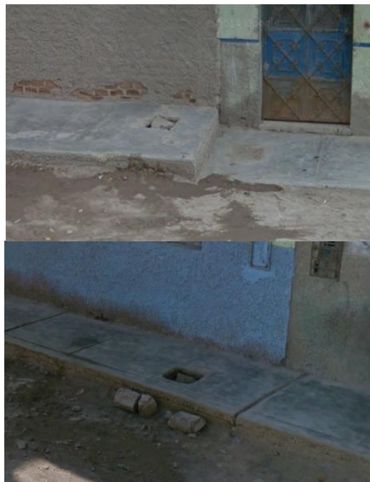
Ilustración 37. Conexiones Domiciliaria de Agua sin tapa
