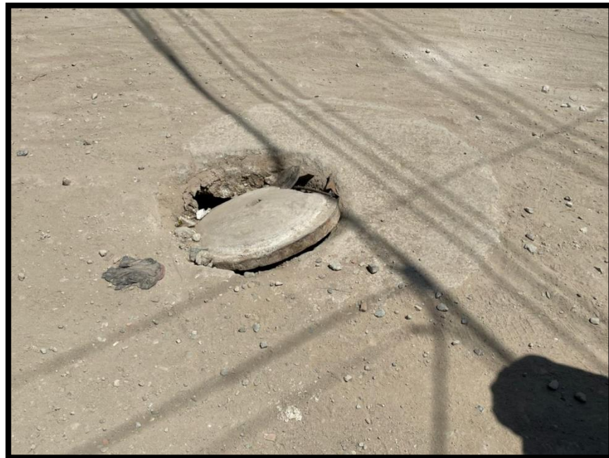
Ilustración 46. Buzón con tapa en mal estado y ubicado entre las calles Jorge Chávez y Antenor Orrego
