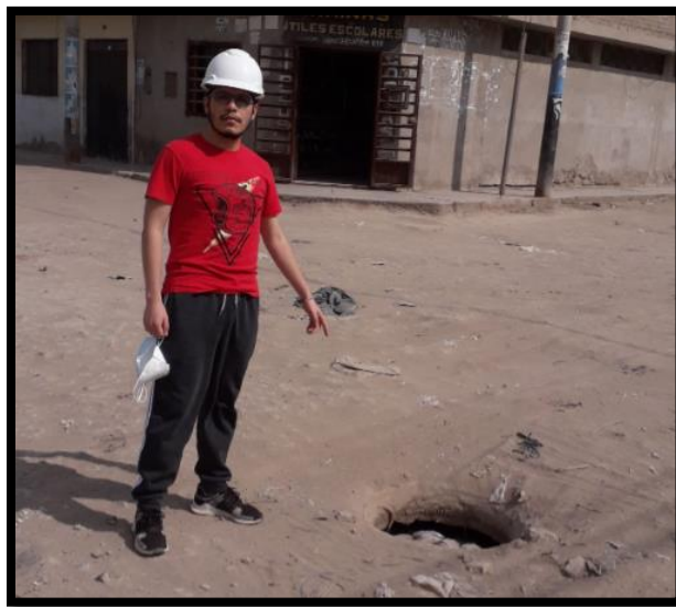
Ilustración 41. Situación actual de uno de los buzones del P.J. San Lorenzo sector 3 (Intersección entre las calles San Felipe y Panamá)
